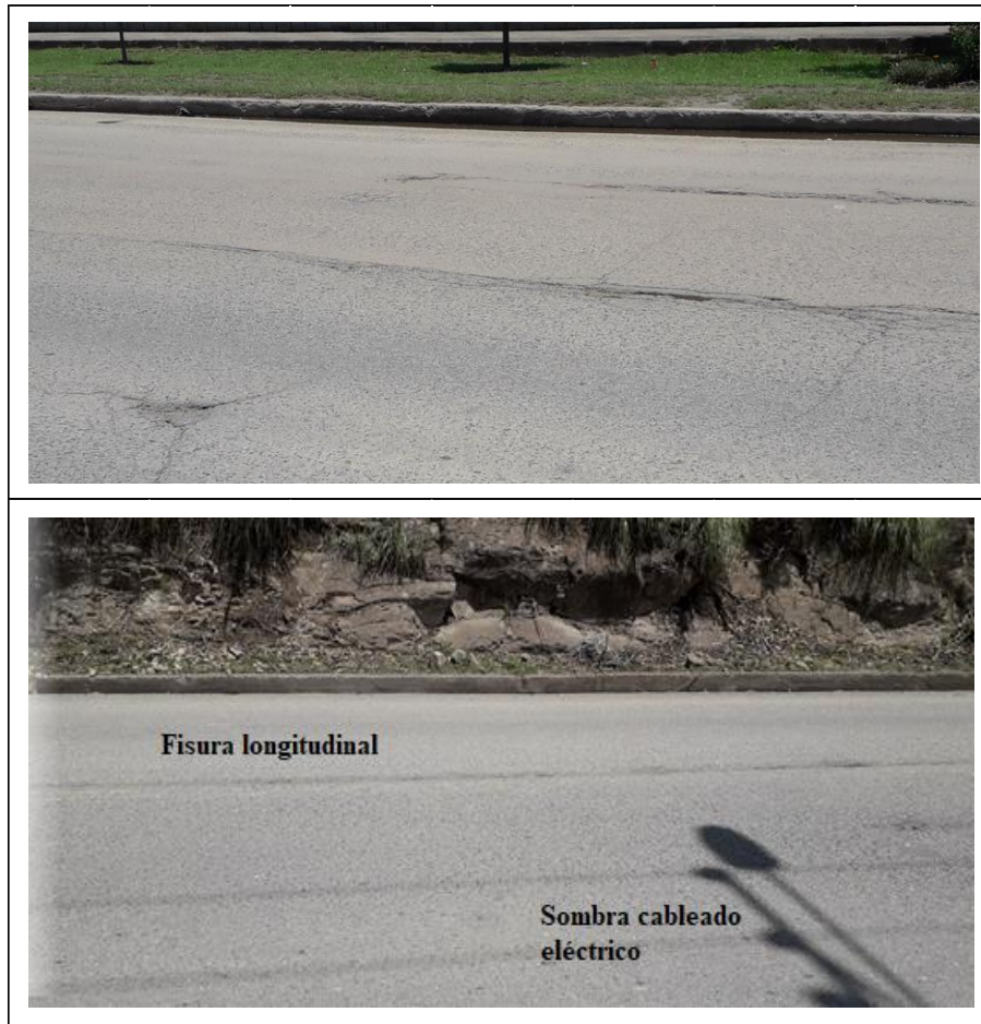
Figura 47. Fisuras longitudinales por junta de carril (2+020 - 4+200)
