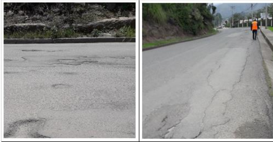
Figura 45. Tratamiento superficial en mal estado 5+600 y 8+200
