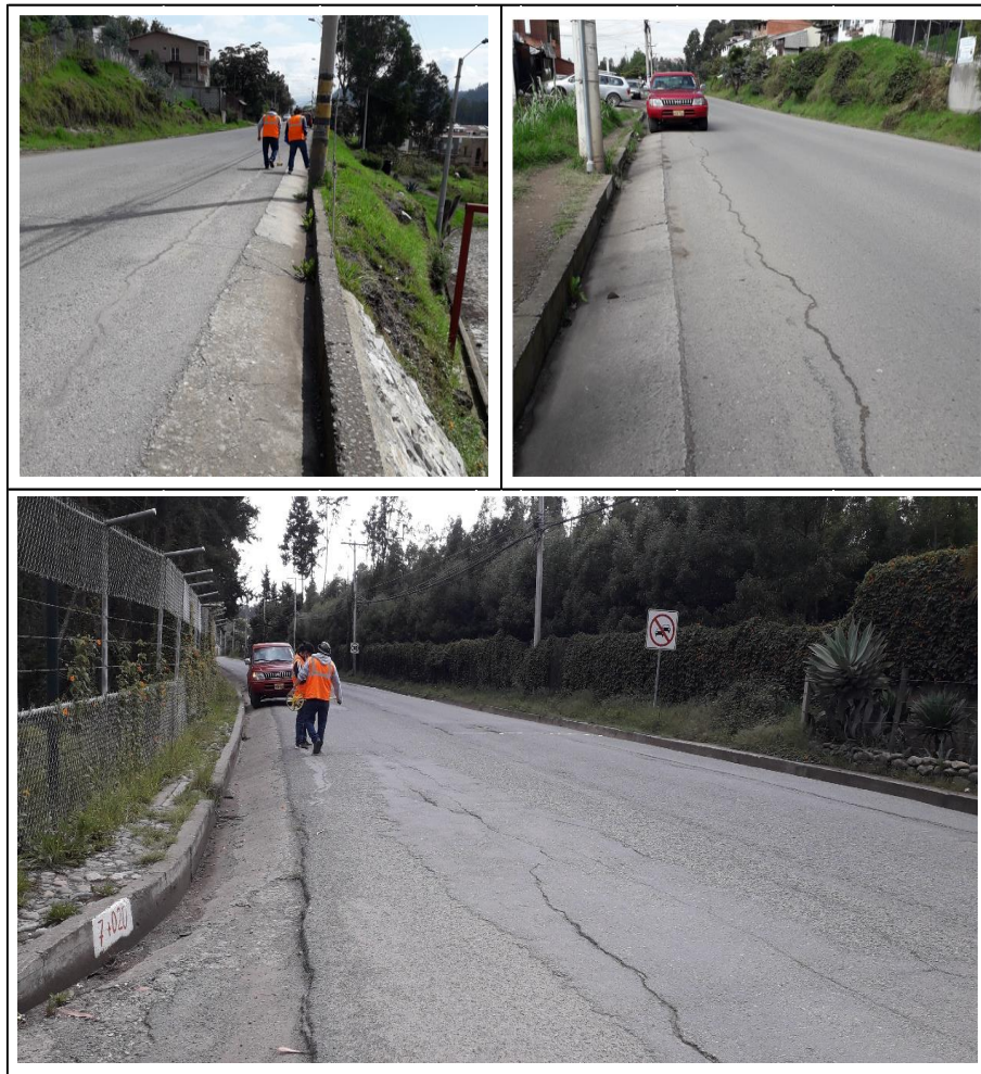
Figura 46. Fisuras longitudinales debido a la falta de confinamiento lateral (0+200 - 0+330 - 7+020)
