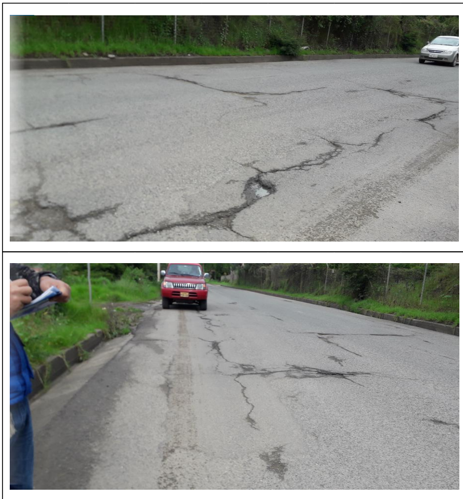
Figura 49. Agrietamiento en bloque (7+800)
