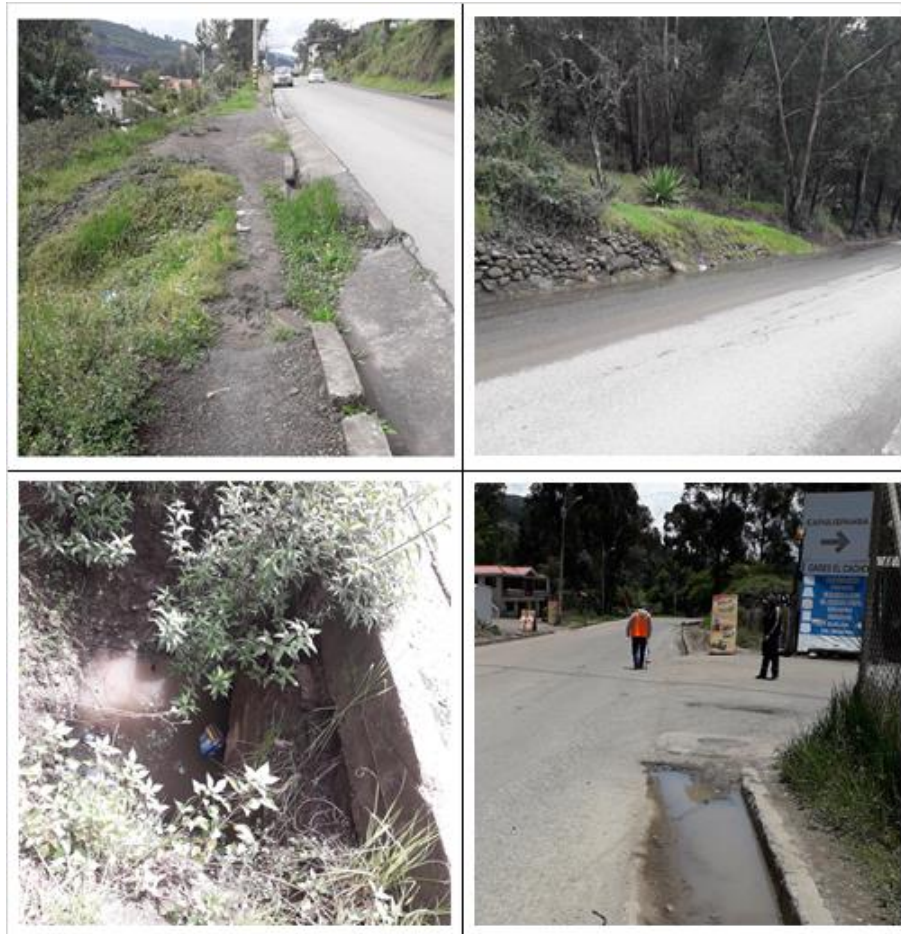
Figura 52. Drenaje en condiciones precarias (0+600), Alcantarilla taponada (1+800), Cuneta sin desfogue (4+400)
