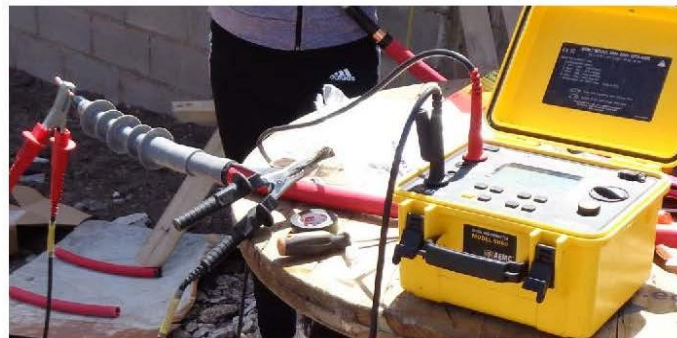
Figura 3. Pruebas de aislamiento del conductor XLPE (con puntas).
