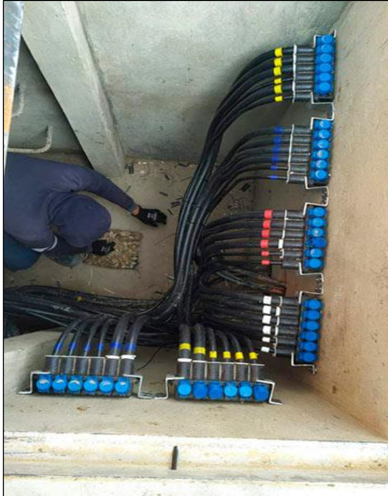
Figura 2. 24 Barras de distribución sumergibles – RG distribuciones S.A. Fuente: (RG distribuciones S.A., 2022)
