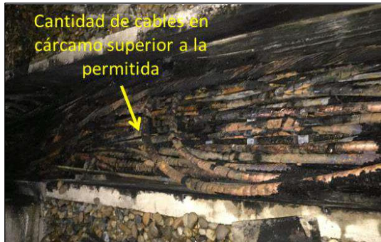
Figura 3. 4 Disposición inadecuada en ductos.
