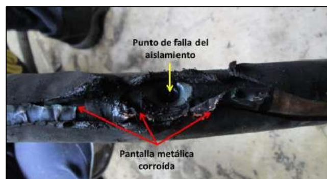
Figura 3. 3 Ingreso de humedad en el cable.
