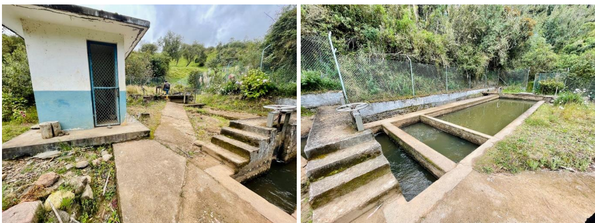
Anexo 5 Sistema de captación de agua cruda de la quebrada Llaucay, microcuenca del río Tabacay
