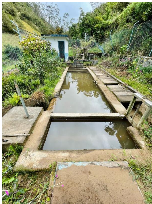
Anexo 2 Sistema de captación de agua cruda de la quebrada Nudpud, microcuenca del río Tabacay
