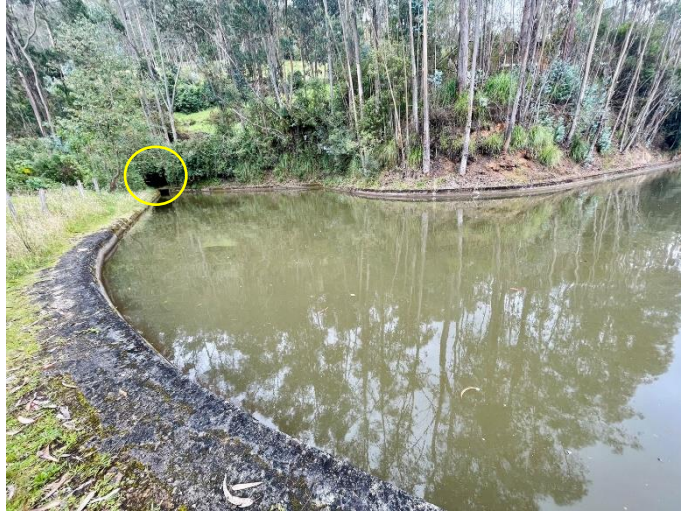
Anexo 10 Reservoirio de agua cruda en la PTAP-M (desembocadura de la línea de conducción de agua cruda de Nudpud y Llaucay). Ingreso del agua cruda de la línea de conducción al reservorio (círculo amarillo)
