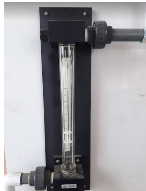
Ilustración 13. Rotámetro. Dosificador de Cloro. Fuente: Abad – Guaraca
