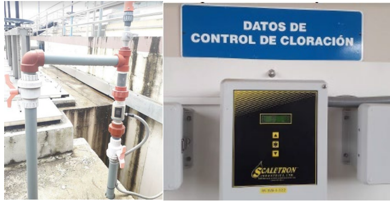
Ilustración 14. Dosificación Cl 2 . (IZQUIERDA). Peso del cilindro de Cloro. (DERECHA). Fuente: Abad – Guaraca
