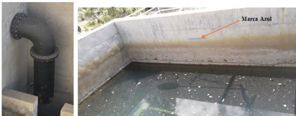
Ilustración 8. Tubería de ingreso de agua hacia los filtros (Izquierda). Marca azul en cada unidad de filtración (Derecha). Referencia modulo II. Fuente: Abad – Guaraca
