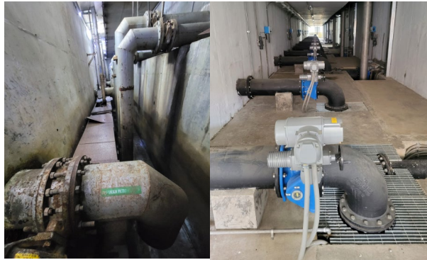
Ilustración 9. Canal de desagüe modulo I (Izquierda). Tuberías de salida, sobre el canal de desagüe, modulo II (Derecha) Fuente: Abad – Guaraca
