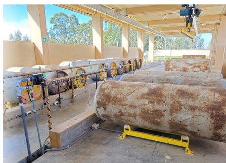
Ilustración 28. Sala de cloración abierta.
