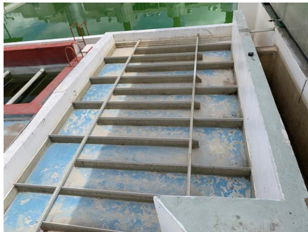
FIGURA 7: MODELO FÍSICO DE LA PRIMERA CÁMARA DEL FLOCULADOR HIDRÁULICO HORIZONTAL UBICADO EN LA CENTRAL TERMOELÉCTRICA "EL DESCANSO".
