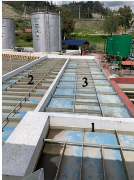
FIGURA 4: FLOCULADOR HIDRÁULICO HORIZONTAL CON TABIQUES CENTRAL TERMOELÉCTRICA “EL DESCANSO”.
