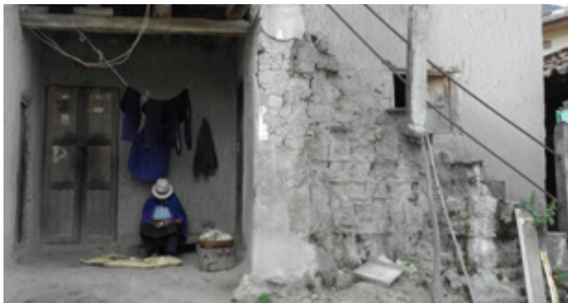
Fig. 05: Estado de deterioro de una vivienda de Susudel. Fausto Cardoso M., 2011.
