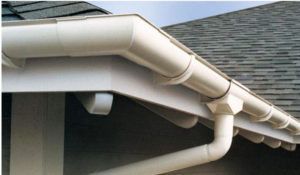
Figura 15. Canaletas, acoples y tubería de conducción.
