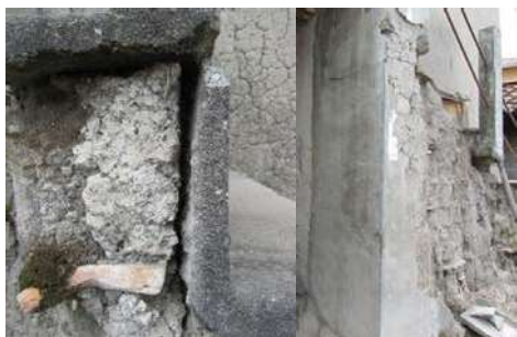
Fig. 2. Desprendimiento de revestimiento de muro en base a arena - cemento
