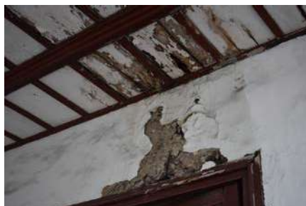
Fig. 6. Daños a causa de filtraciones de agua de cubierta.
