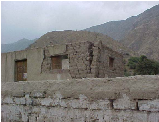
Figura 2. Grieta vertical en esquina superior de muro, Castilla, Arequipa, 2001. Crédito: D. Quiun
