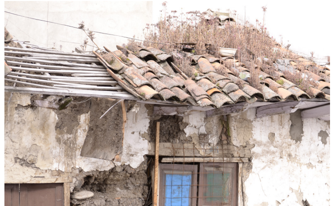
Fig. 4: Vivienda patrimonial en deterioro. Barrio El Vado. Fuente: Proyecto vli r CPM, 2015
