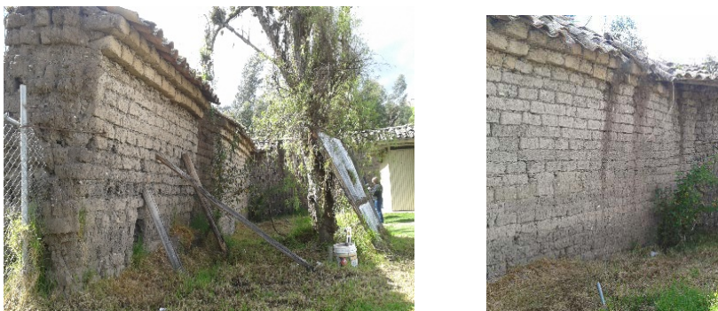
Figura 1 – Muro 1: Cerramiento del Hospital Mariano Estrella, mayo 2015
