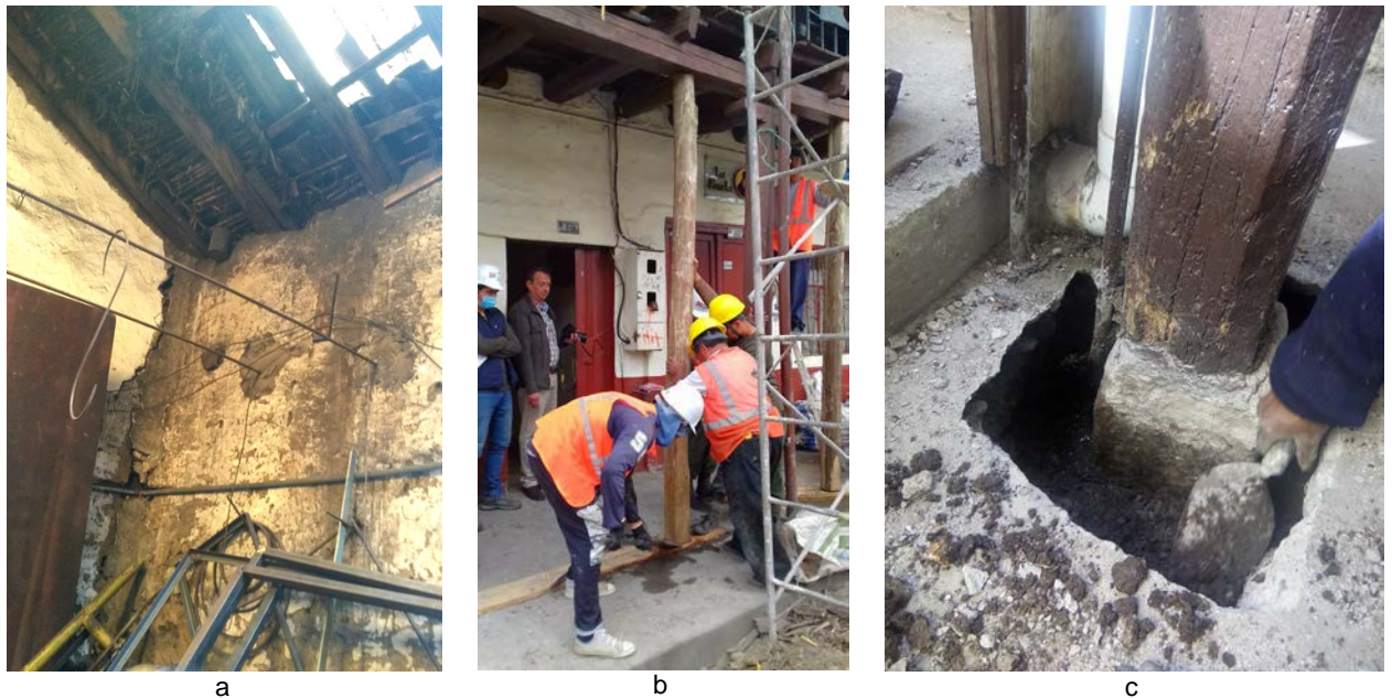
Figura 2. Barrio El Vergel: a) Tensores que sujetan la fachada principal de una de las edificaciones; b) Apuntalamiento para sustitución de columnas, Campaña 2018; c) Base de piedra en columna, por debajo del nivel del piso (Fuente: Proyecto Ciudad Patrimonio Mundial)
