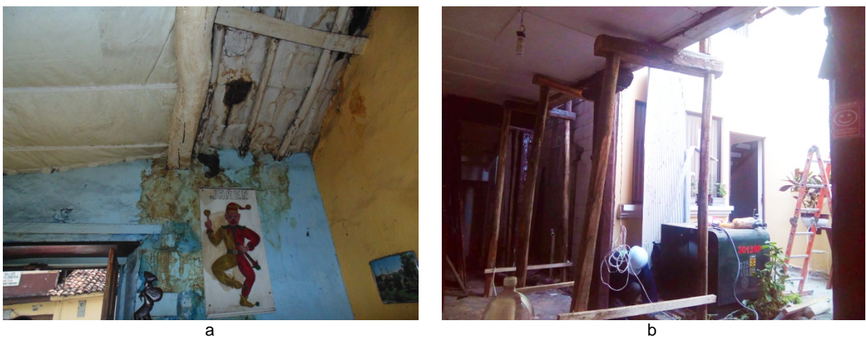
Figura 3. a) Humedad y manchas en cielo raso y muros internos, producidos por filtración de agua; Autor: Gabriela Barsallo. b) Apuntalamiento tipo puente, para sustitución de columnas e incorporación de bases (Fuente: Proyecto Ciudad Patrimonio Mundial)
