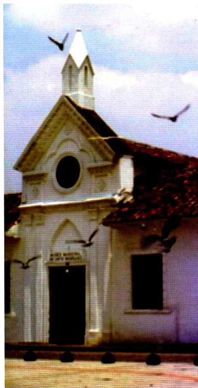
El edificio en etapa de restauración y adecuación para su nuevo uso, Cuenca, C. 1980 (MC).
