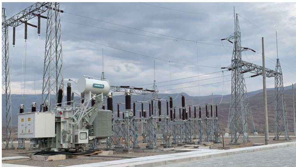
Figura 3.24 Fotografía subestación eléctrica Uchucay. [ELECAUSTRO S.A]
