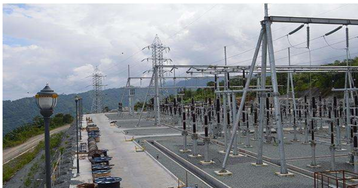
Figura 3.25 Fotografía subestación Minas [CELEC EP]
