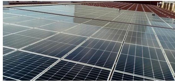
Figura 2.17: Cubiertas con superficies PV Fuente: Energía de Castilla, 2020
