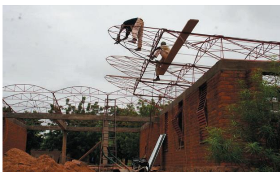
Figura 2.26: Extensión de Escuela Secundaria en Dano, Burkina Faso – Estructura de la cubierta Fuente: Arquitectura Viva, 2018
