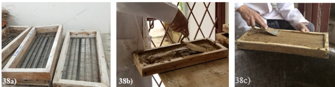
Figura 38 Foto del Soporte 38a), aplicación de 1° capa 38b), aplicación de 2° capa (pañete) 38c).
