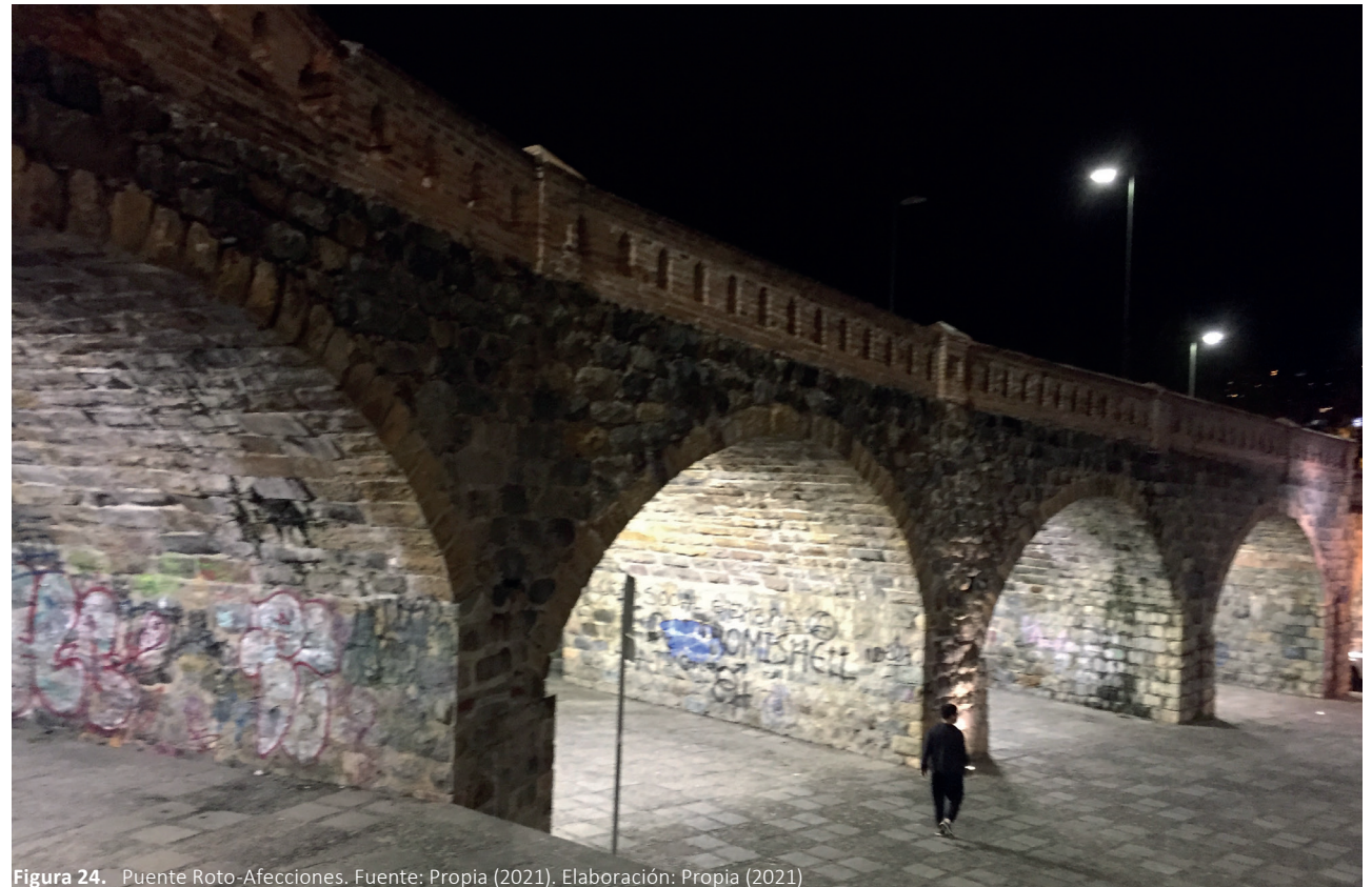
Figura 24. Puente Roto-Afecciones. Fuente: Propia (2021), Elaboración: Propia (2021)
