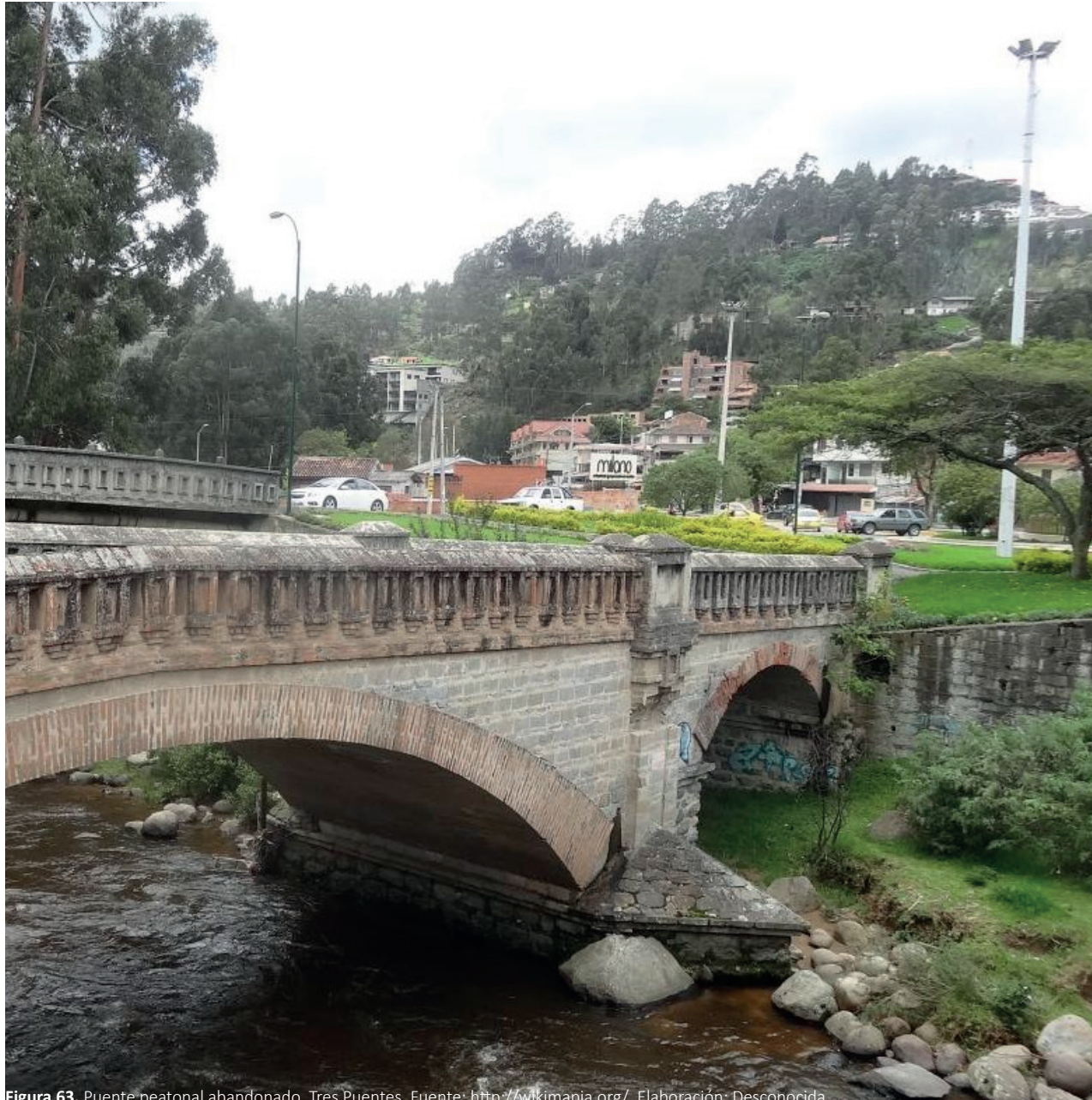
Figura 63. Puente peatonal abandonado, Tres Puentes. Fuente: http://wikimapia.org/ . Elaboración: Desconocida.
