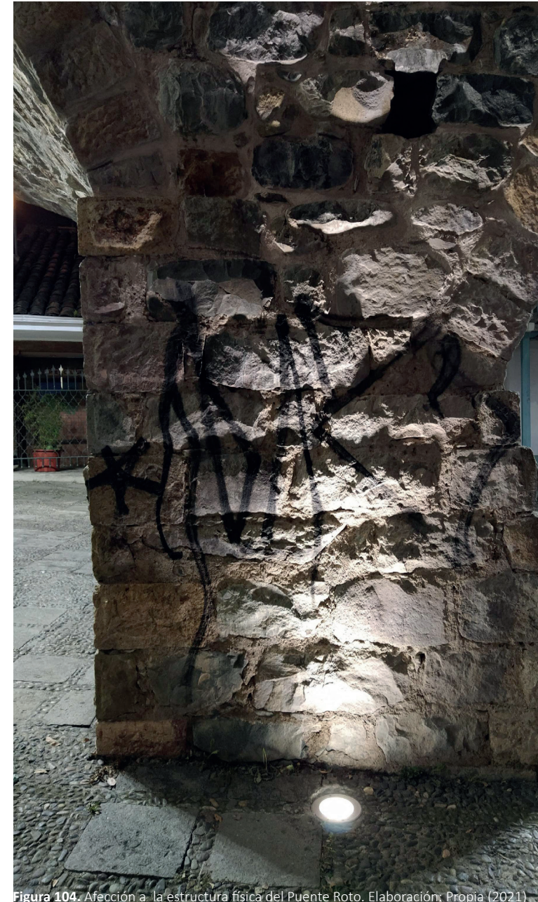
Figura 104. Afección a la estructura física del Puente Roto. Elaboración: Propia (2021)
