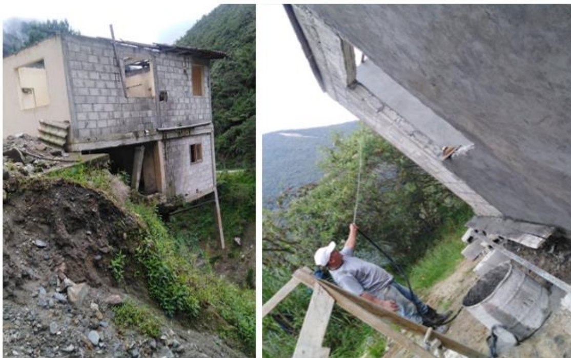
Foto 2 Casa destruida y casa en reposición para afectados
