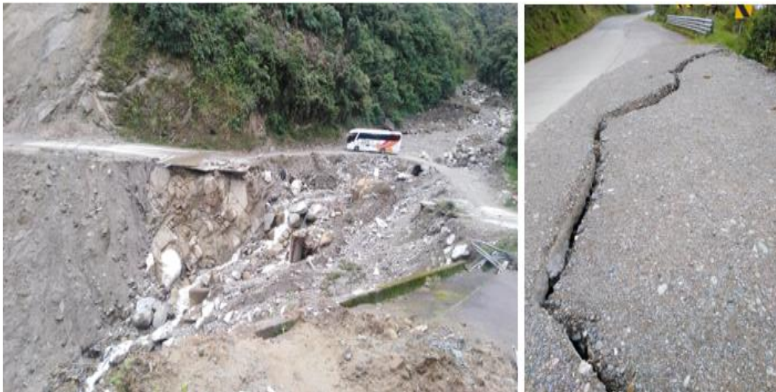
Foto 5 Carretera E-40 en la quebrada Jurupis
