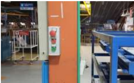
Figura 118: Pulsante de parada de emergencia (zona 2) Fuente: Javier Rodas López
