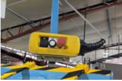
Figura 117: Pulsante de parada de emergencia (zona 1) Fuente: Javier Rodas López
