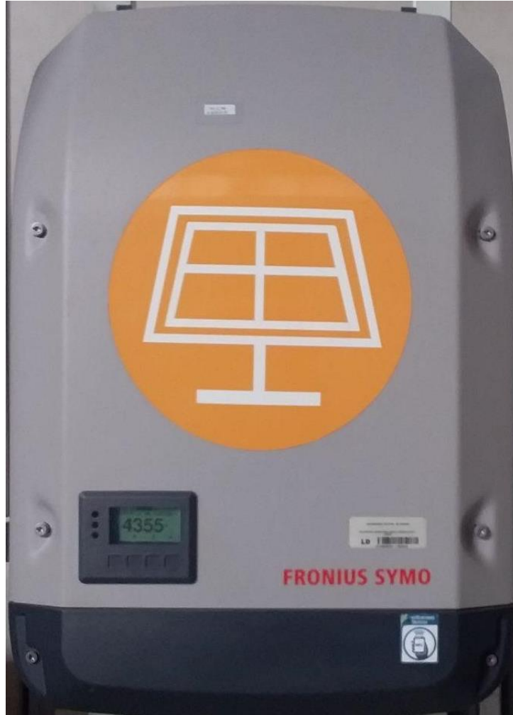
Figura 4-7 Api Paneles Solares
