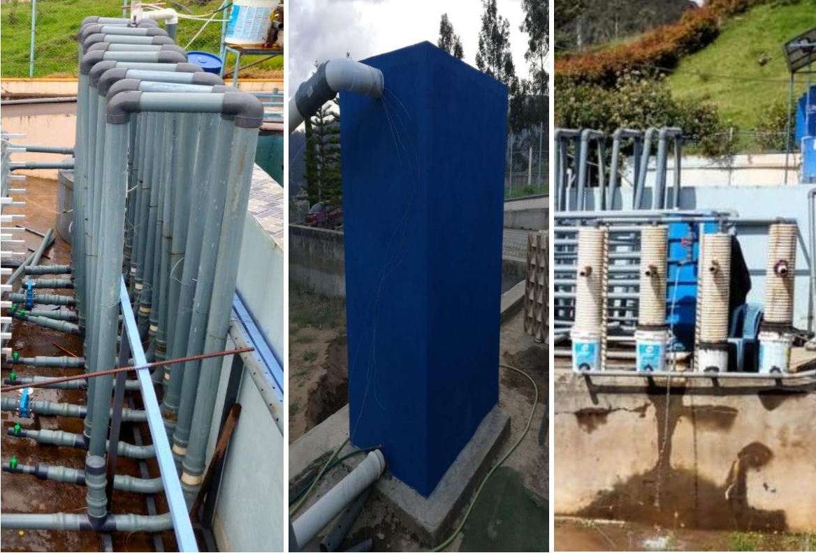
Figura 4. De izquierda a derecha, FTV piloto, sedimentador y filtro.
