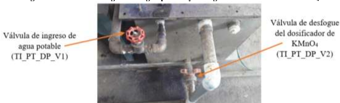
Figura 14. Válvulas de ingreso de agua potable y desfogue del dosificador de KMnO_4
