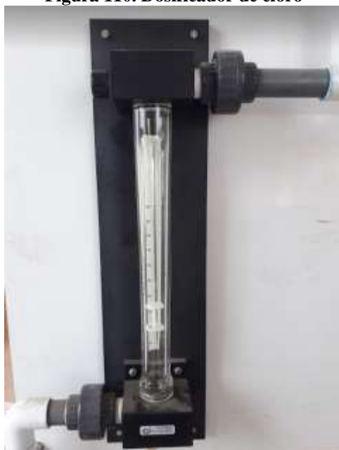
Figura 110. Dosificador de cloro
