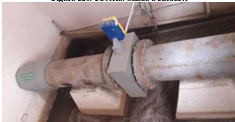
Figura 128. Tubería: Salida a Ricaurte
