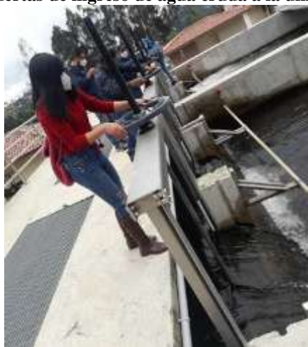
Figura 23. Compuertas de ingreso de agua cruda a la unidad de oxidación 1
