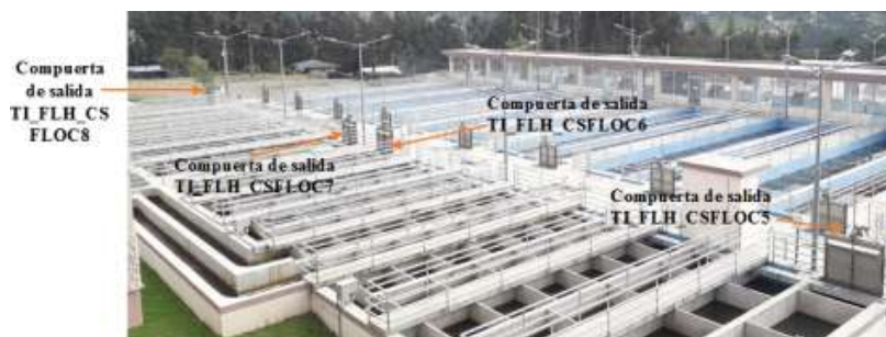
Figura 76. Compuertas de salida de cada unidad de floculación
