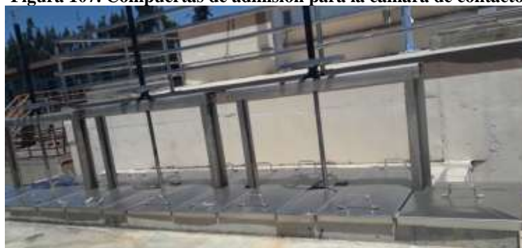
Figura 107. Compuertas de admisión para la cámara de contacto
