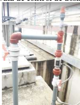
Figura 115. Válvula de control de dosificación de Cloro
