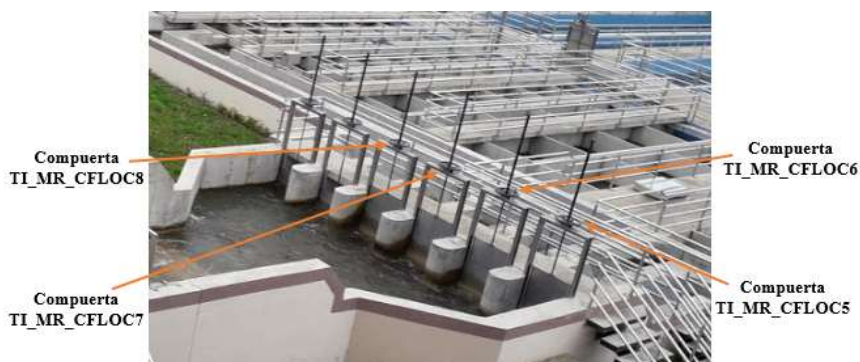
Figura 75. Compuertas de carga de las unidades de floculación
