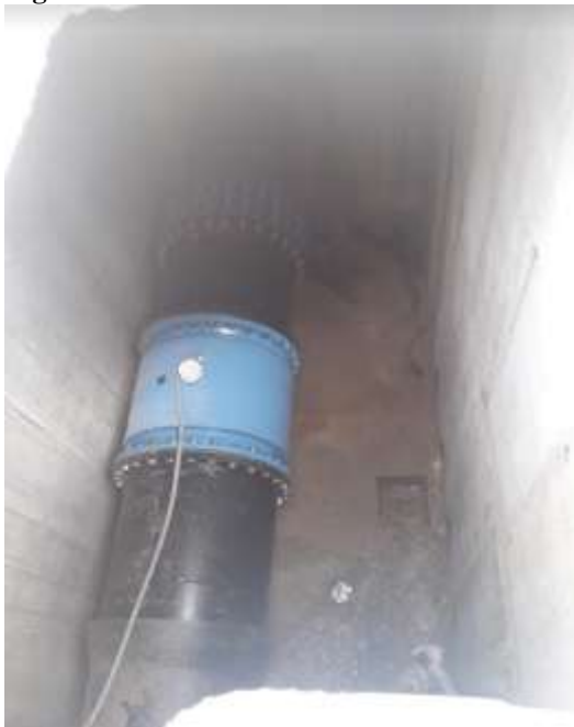
Figura 127. Tubería de conducción de 900mm
