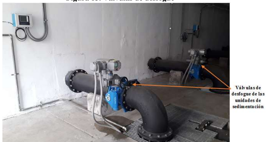
Figura 83. Válvulas de desfogue
