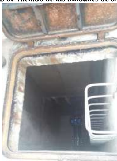
Figura 25. Válvulas de vaciado de las unidades de oxidación y aireación
