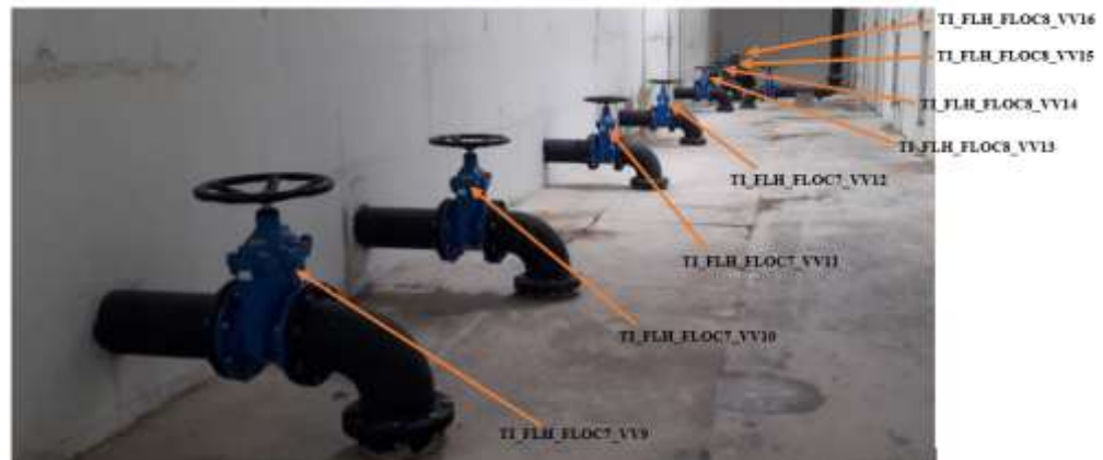
Figura 78. Válvulas de vaciado de las unidades de floculación
