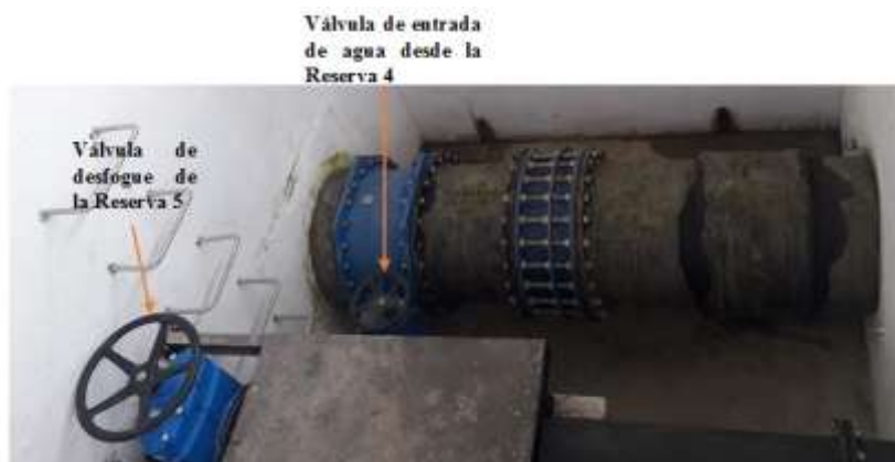
Figura 122. Válvula de entrada de agua desde la Reserva 4
