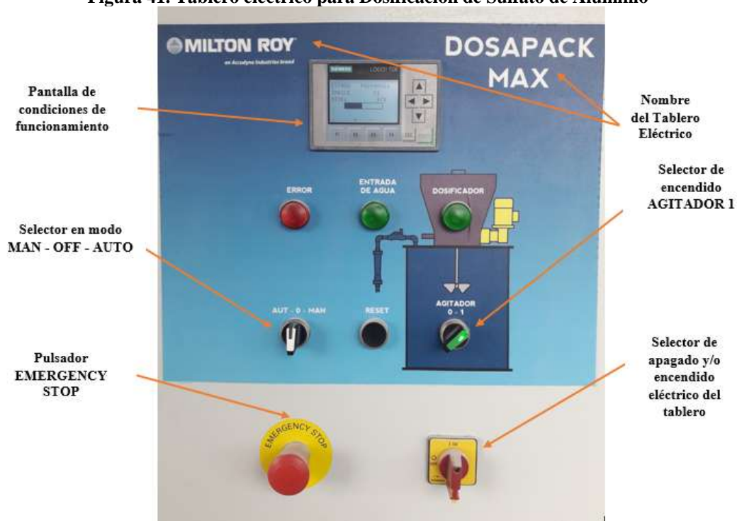
Figura 41. Tablero eléctrico para Dosificación de Sulfato de Aluminio
