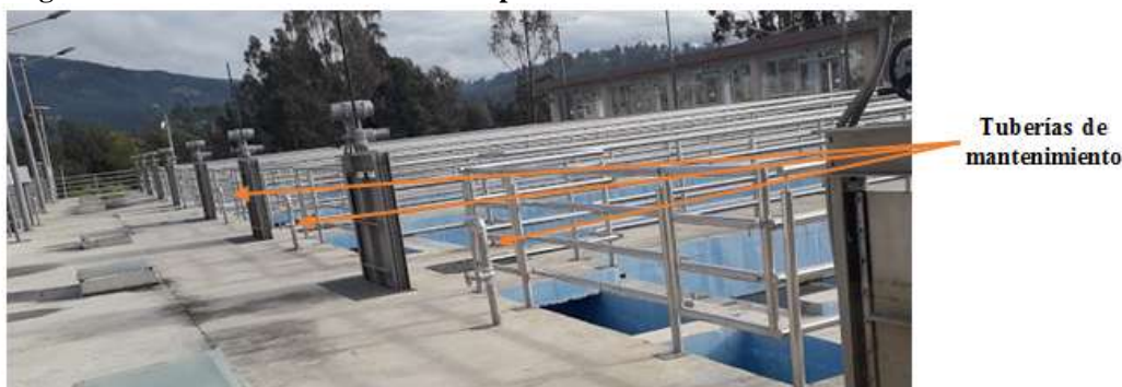
Figura 89. Tuberías de mantenimiento para las unidades de sedimentación
