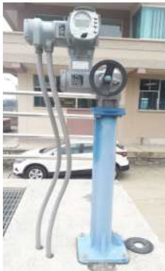
Figura 30. Compuerta de ingreso de agua cruda hacia el Módulo 1 (Actuador 3)
