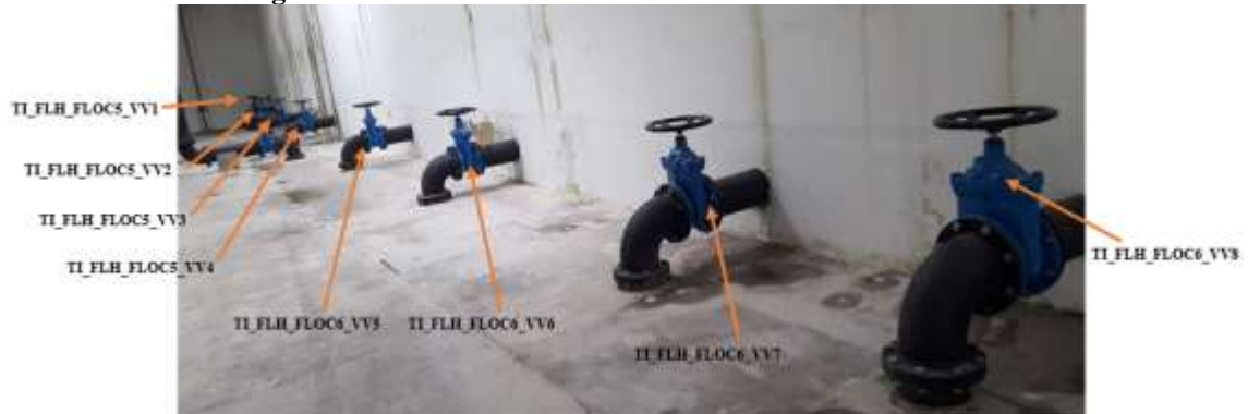
Figura 77. Válvulas de vaciado de las unidades de floculación
