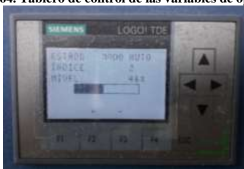
Figura 64. Tablero de control de las variables de operación
