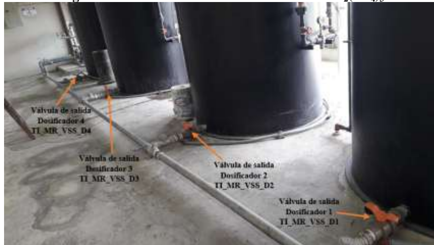
Figura 44. Válvulas de salida de la solución de Al_2(SO_4)_3
