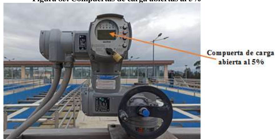
Figura 85. Compuertas de carga abiertas al 5%
