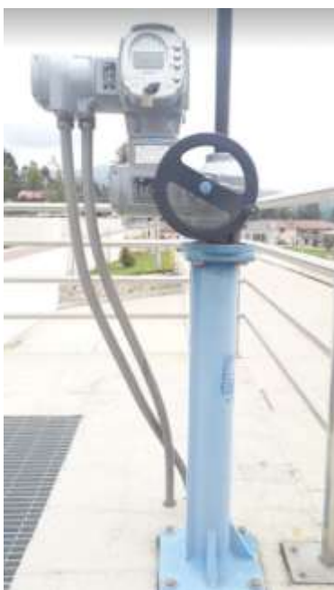
Figura 54. Compuerta de ingreso al Módulo II y III (Actuador 4)
