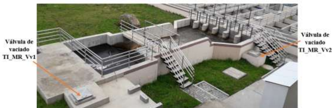
Figura 57. Válvulas de vaciado TI_MR_Vv1 y TI_MR_Vv2
