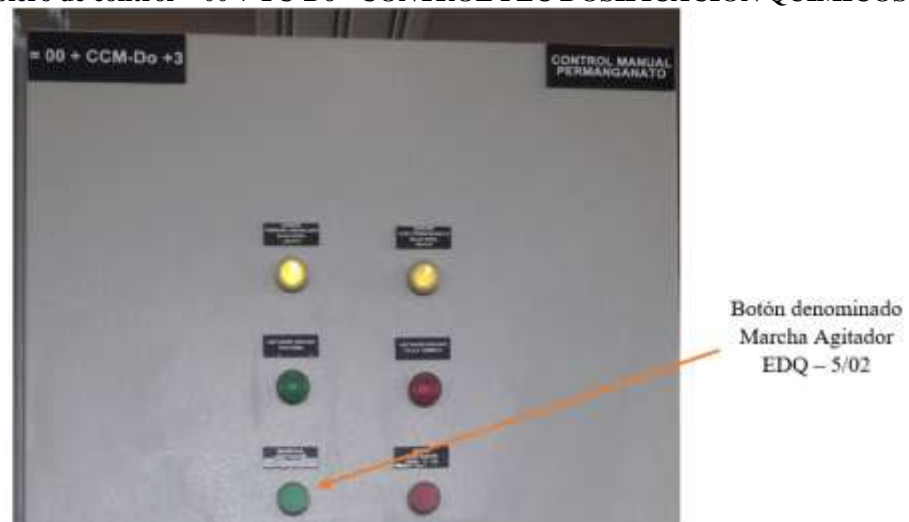
Figura 20. Tablero de control = 00 + TC-Do - CONTROL PLC DOSIFICACIÓN QUÍMICOS
