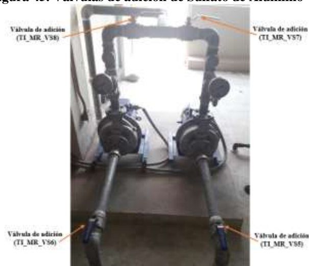
Figura 45. Válvulas de adición de Sulfato de Aluminio
