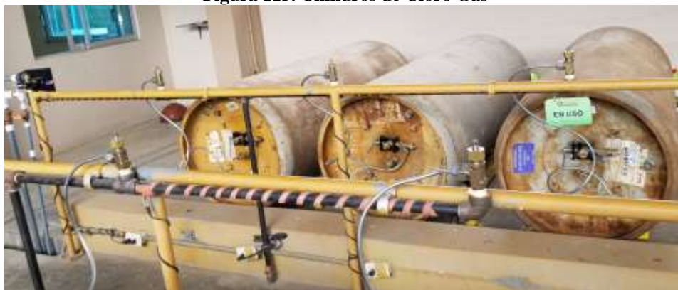
Figura 113. Cilindros de Cloro Gas
