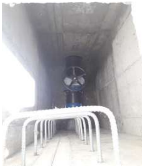
Figura 116. Válvula de vaciado de la Cámara de contacto
