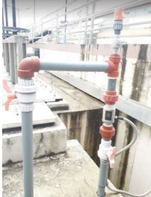
Figura 111. Dosificación de Cloro a la cámara de contacto
