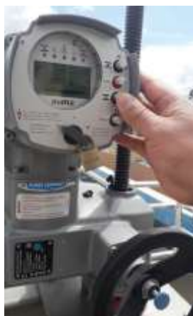
Figura 61. Actuador de la compuerta de salida de las unidades de floculación
