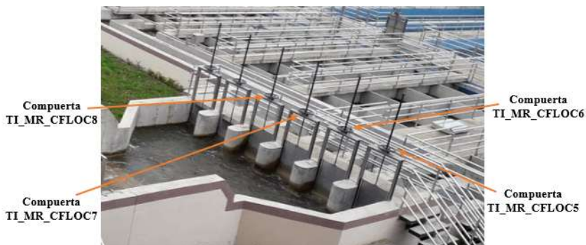
Figura 58. Compuertas de carga de las unidades de floculación
