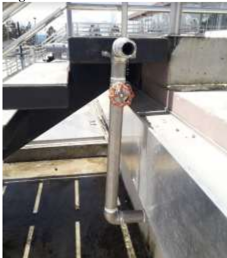
Figura 105. Tubería de mantenimiento
