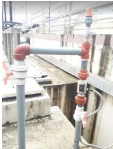
Figura 118. Válvula de control de dosificación de Cloro
