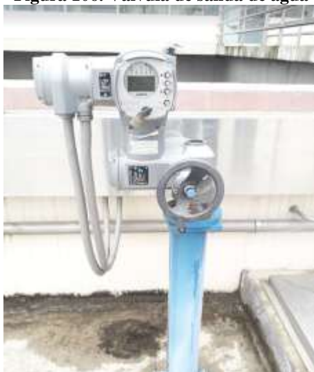
Figura 106. Válvula de salida de agua
