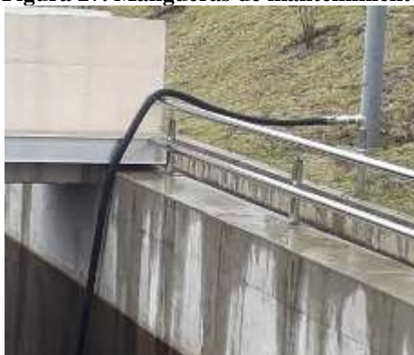
Figura 27. Mangueras de mantenimiento
