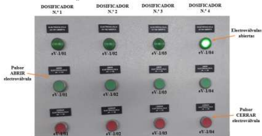
Figura 49. Control de electroválvulas
