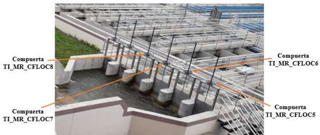
Figura 56. Compuertas de carga de las unidades de floculación
