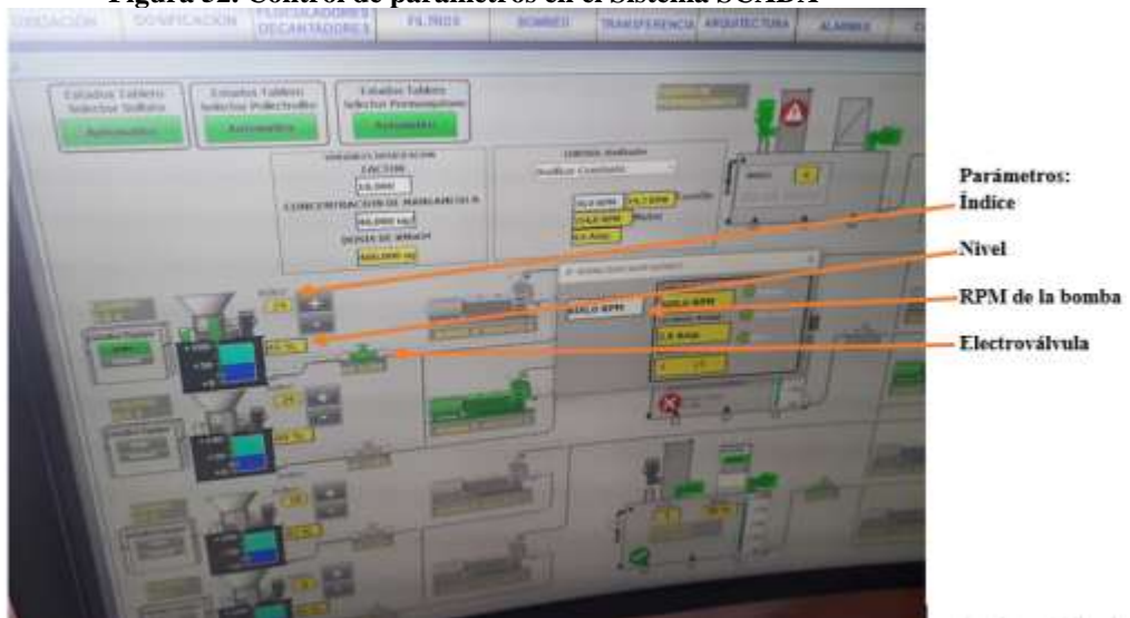
Figura 52. Control de parámetros en el Sistema SCADA
