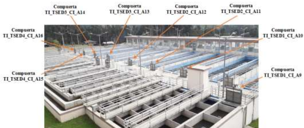
Figura 82. Compuertas de carga hacia las unidades de sedimentación
