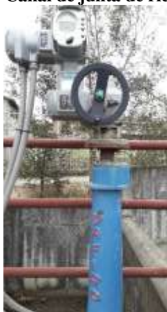
Figura 2. Actuador 1 - Canal de junta de riego del río Machángara
