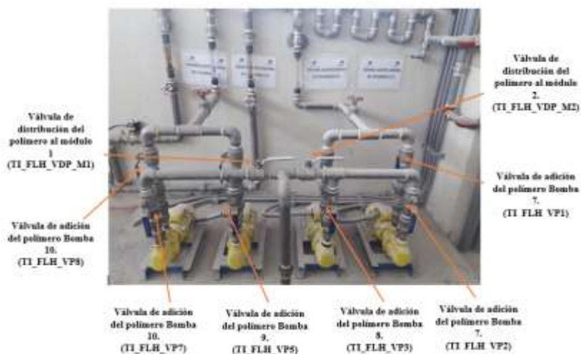
Figura 67. Válvulas de adición de Solución de Polímero
