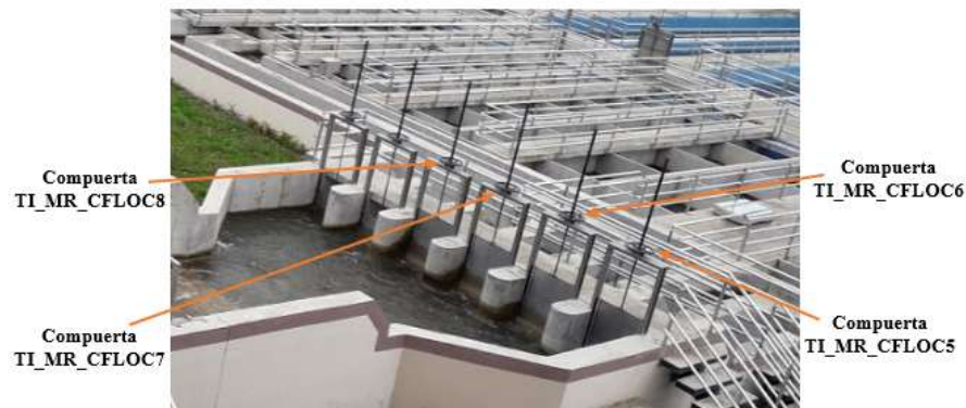
Figura 33. Compuertas de carga de las unidades de floculación
