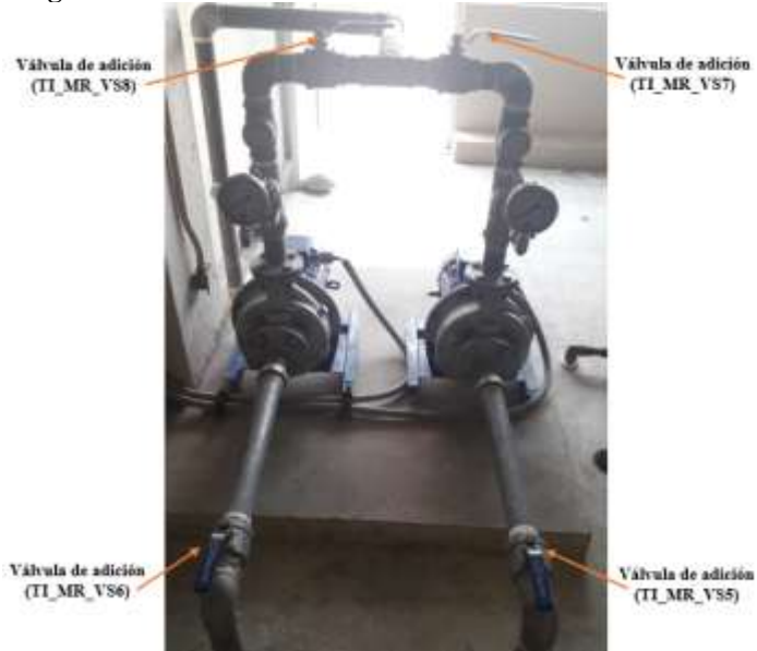
Figura 55. Válvulas de adición de Sulfato de Aluminio
