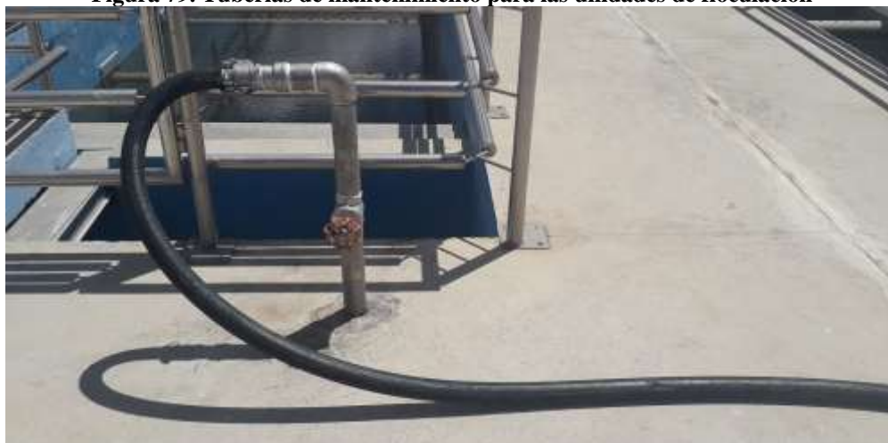
Figura 79. Tuberías de mantenimiento para las unidades de floculación
