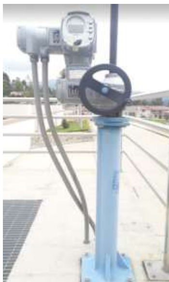
Figura 31. Compuerta de ingreso de agua cruda hacia el Módulo 2 (Actuador 4)
