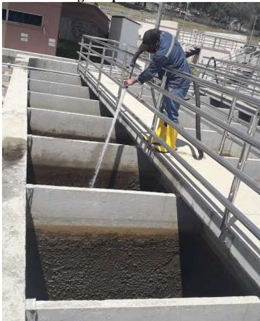
Figura 80. Lavado con agua a presión de las unidades de floculación
