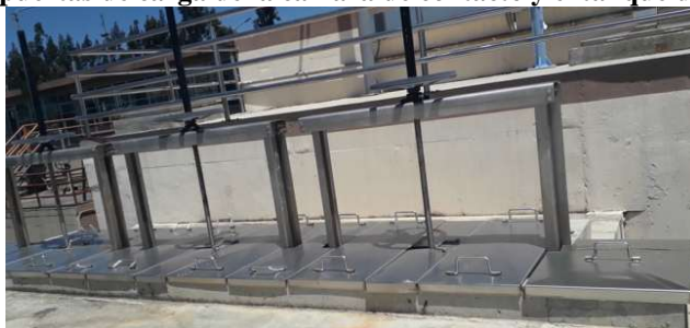
Figura 114. Compuertas de carga de la cámara de contacto y el tanque de almacenamiento
