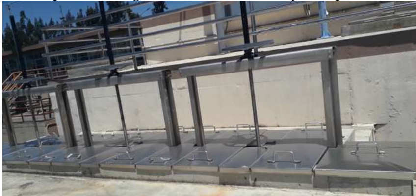
Figura 117. Compuertas de carga de la cámara de contacto y el tanque de almacenamiento
