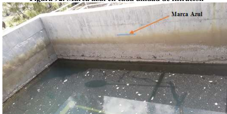
Figura 92. Marca azul en cada unidad de filtración
