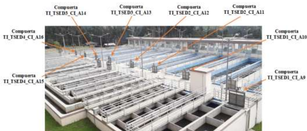
Figura 87. Compuertas de carga hacia las unidades de sedimentación
