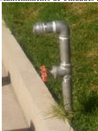
Figura 26. Tuberías de Mantenimiento de Unidades de Oxidación y Aireación
