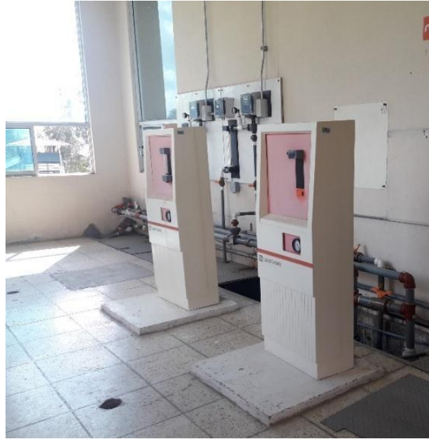
Figura 42. Paneles de control automatizado de cloro gas
