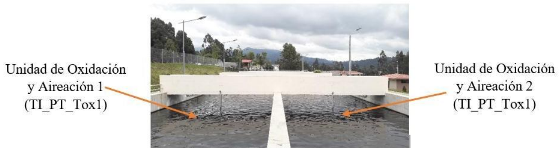
Figura 20. Unidades de proceso de oxidación y aireación
