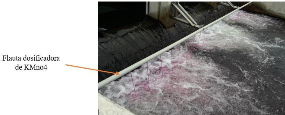
Figura 22. Dosificación de la solución de permanganato de potasio
