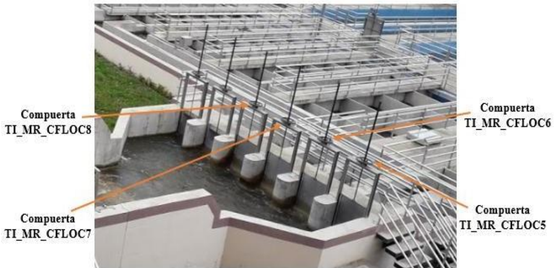
Figura 25. Compuerta de las unidades de floculación
