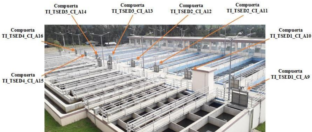
Figura 27. Compuerta de carga hacia unidades de sedimentación
