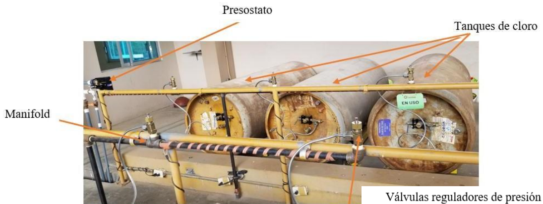
Figura 41. Sistema de dosificación de cloro gas
