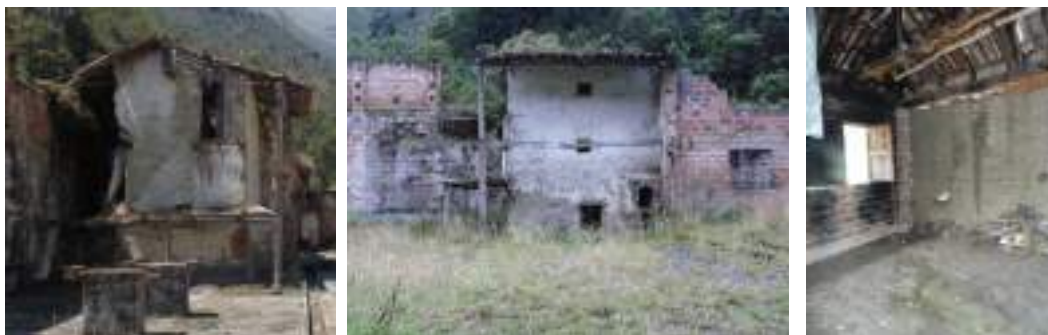
Figura 7: Estado de conservación de elementos construidos con tierra en la Antigua Hacienda de Llaviucu, año 2016 (acervo del Proyecto vlirCPM)
