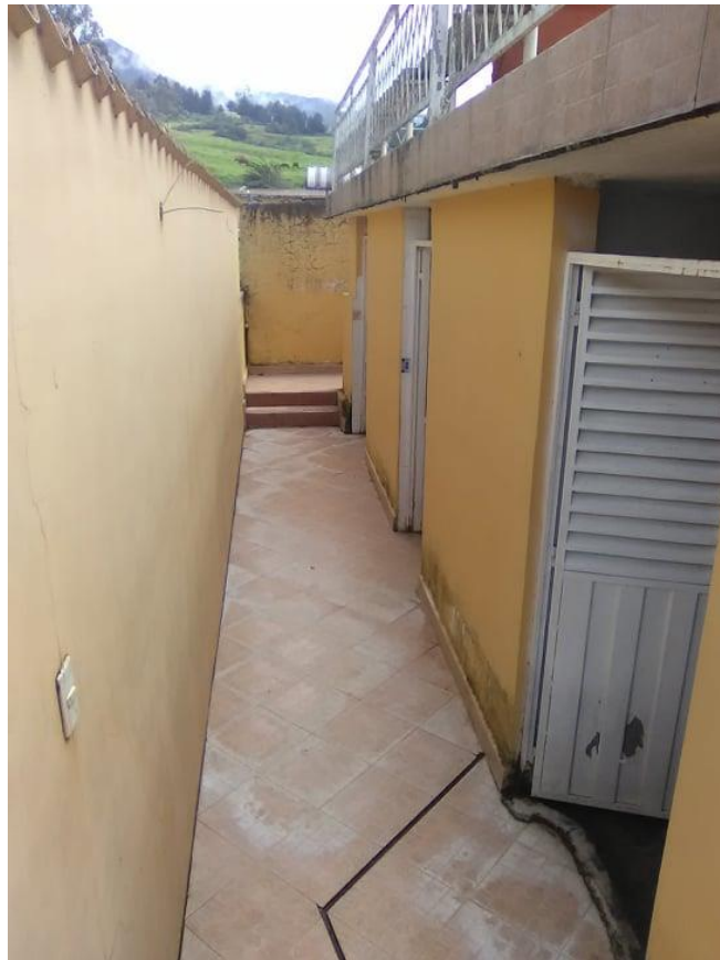
Vestidores del área de la piscina sin el mantenimiento adecuado
