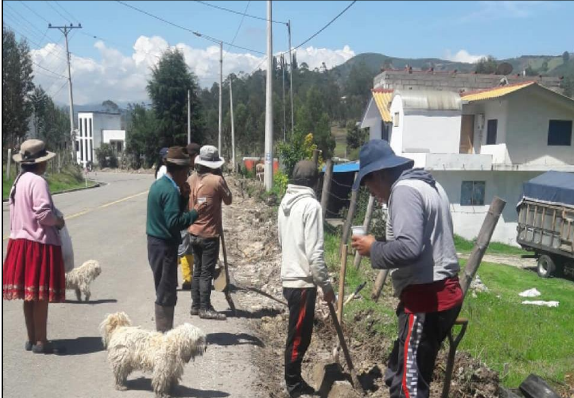
Figura 2 Miembros del sistema de agua de Tarqui-Victoria del Portete trabajando en la colocación de tuberías de agua.
