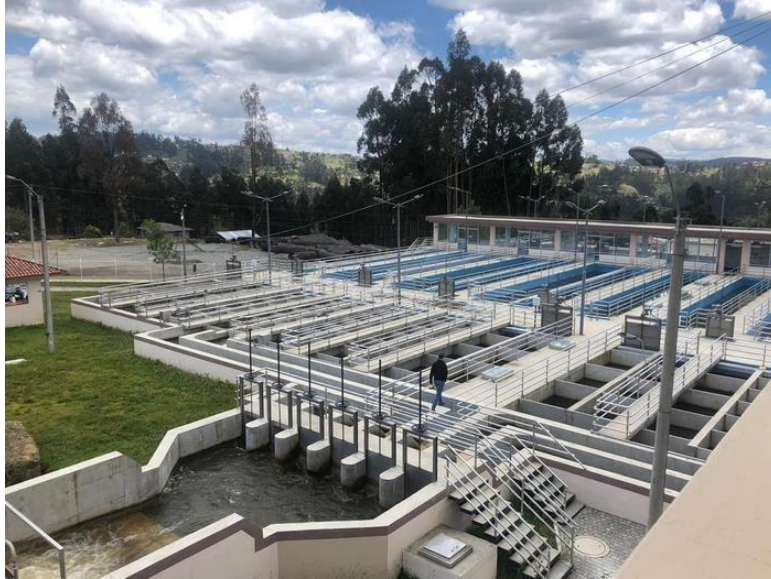
Ilustración 2 Planta de tratamiento de agua de Tixán
