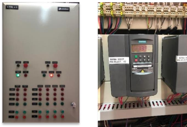
Ilustración 45 Dispositivo para seleccionar frecuencia de la bomba. Tablero TDL+3.
