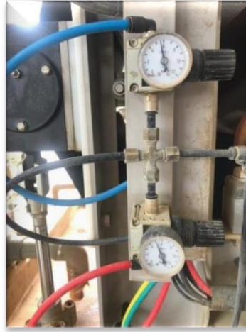
Ilustración 78. Manómetro de filtro.
