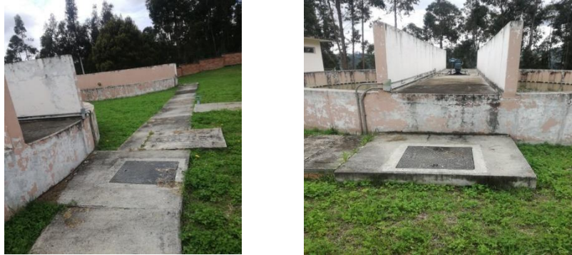
Ilustración 33. Depósito de válvula manual de espesador.
