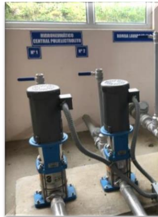
Ilustración 39. Bombas para transporte de agua.
