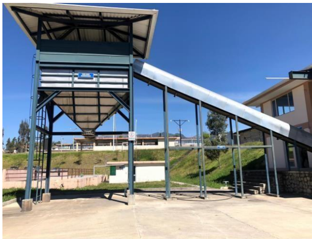
Ilustración 74. Tolva de lodos deshidratados.
