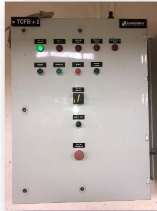
Ilustración 61 Tablero para control del proceso de filtración
