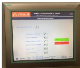
Ilustración 67 Tablero de encendido de filtros en sistema SCADA.
