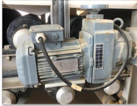
Ilustración 49 Bomba para proceso de filtración
