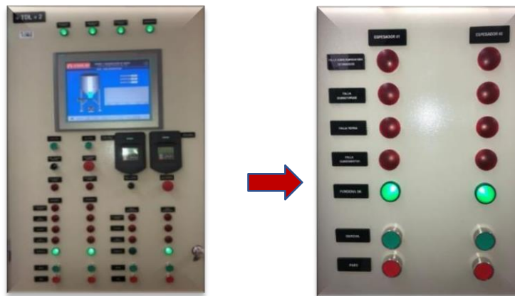
Ilustración 41 Tablero TDL+2 para espesadores.
