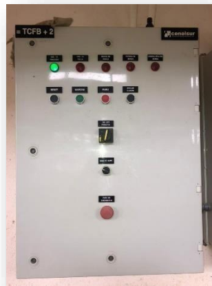
Ilustración 51. Tablero para control del proceso de filtración.
