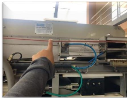
Ilustración 69. Cinta roja paro de emergencia de filtro.
