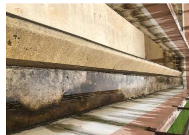
Ilustración 12. Salida de drenaje a río.
