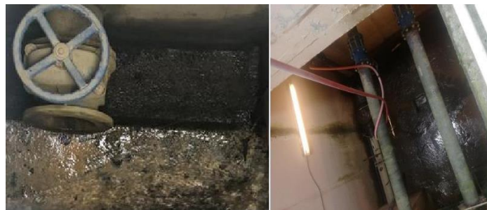
Ilustración 23 Válvula de desfogue en la zona del tanque espesador.
