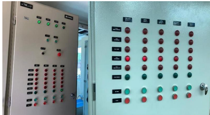
Ilustración 22. Botón de encendido de bombas en el tablero 1.1-1.7 y 2.1-2.7.
