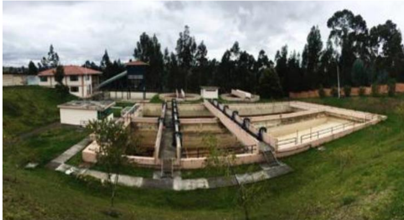
Ilustración 3: Planta de tratamiento de lodos de Tixán
