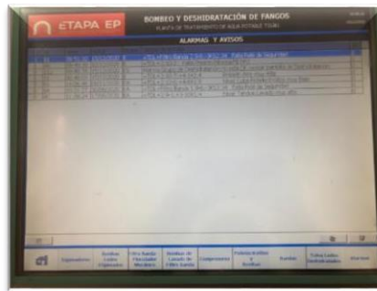
Ilustración 76. Sistema de reseteo de alarmas en el tablero.
