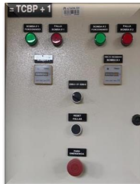
Ilustración 46 Tablero de bombas de polielectrolito.
