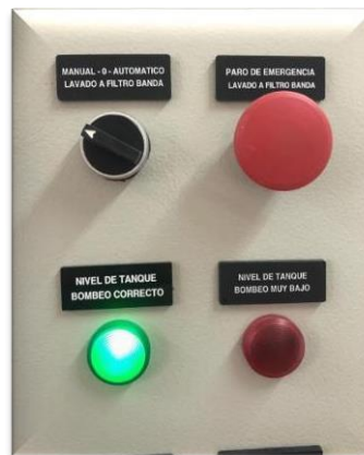
Ilustración 62 Tablero para encendido de bomba de lavado del filtro
