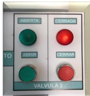
Ilustración 24. Botones para abertura de válvulas.
