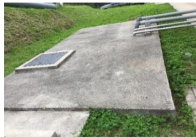
Ilustración 38. Depósito de agua.
