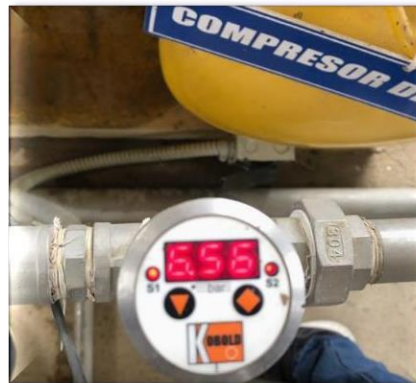
Ilustración 72. Presión de compresores 6 bares.
