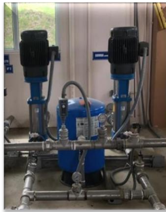
Ilustración 60 Bombas de lavado de filtro.
