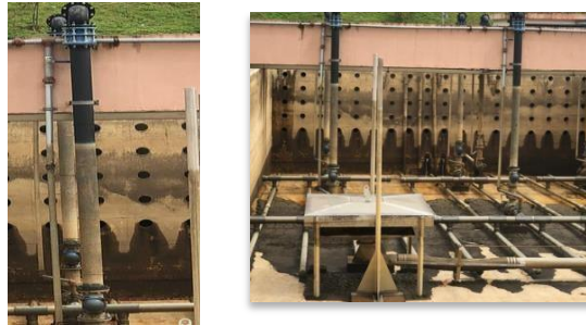
Ilustración 28 Tuberías y flautas del tanque decantador.
