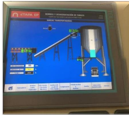
Ilustración 75. Nivel de tolva en tablero.
