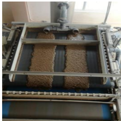
Ilustración 58 Lodo floculado en filtro banda.
