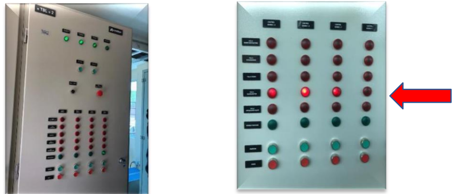
Ilustración 21 Tablero de bombas para iniciar su funcionamiento.
