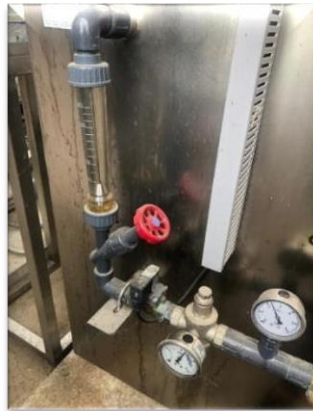
Ilustración 43 Válvula de caudal del tanque polielectrolito.
