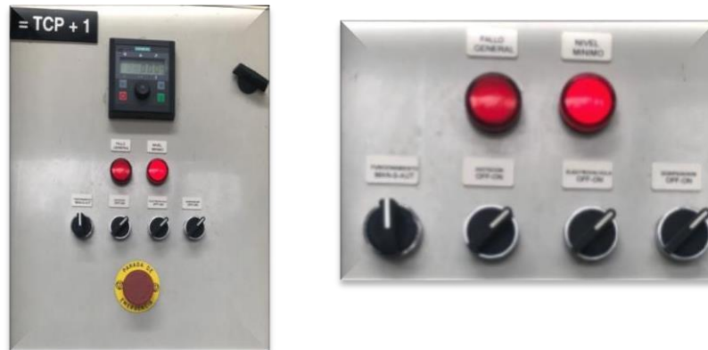
Ilustración 46 Tablero de control de dosificación de polímero.
