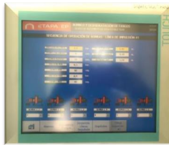
Ilustración 25. Pantalla donde se puede visualizar el funcionamiento de las bombas.
