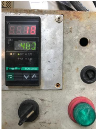
ilustración anexo 1. Caja de control del horno.
