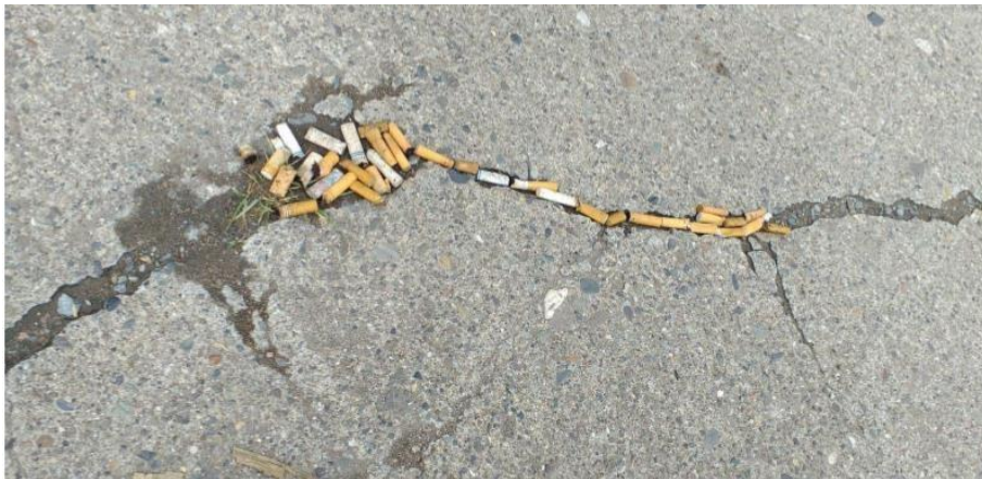
Ilustración 39, colillas de tabaco distribuidas en la grieta.
