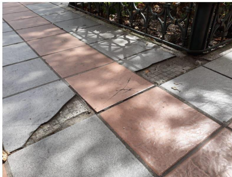
Ilustración 56, vista frontal: vereda derecha, en referencia al sentido direccional de la calle; segmento con baldosa incompleta, localización: calle Mariscal Sucre y Benigno Malo.
