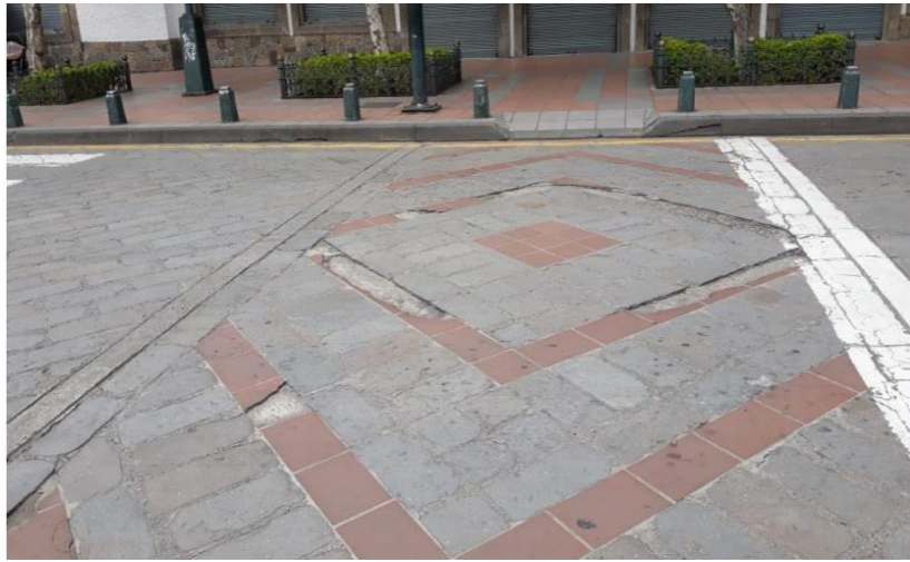
Ilustración 55, vista frontal: grieta en la calle y segmento con ausencia de baldosas, localización: calle Mariscal Sucre y Luis Cordero.
