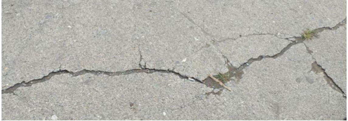
Ilustración 38, fotografía de grieta sobre la vereda.
