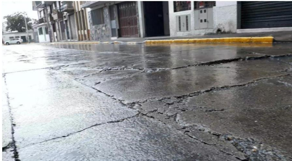
Ilustración 25, Fotografía de grieta en la Calle Miguel Vélez, entre la Calle Mariscal Sucre y Simón Bolívar.
