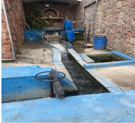
Ilustración 14: Área de mezclado-Planta de Tratamiento de Agua Potable de Cochapamba Fuente: Elaboración Propia
