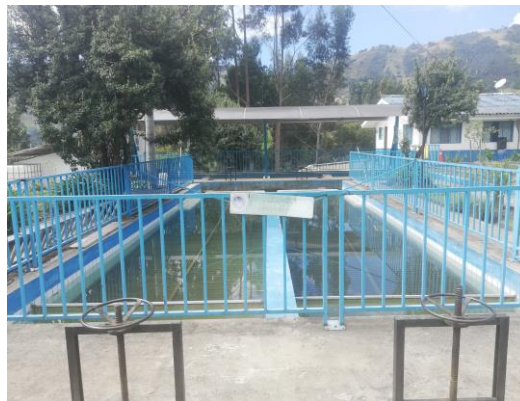
Ilustración 16: Sedimentadores-Planta de Tratamiento de Agua Potable de Cochapamba Fuente: Elaboración Propia
