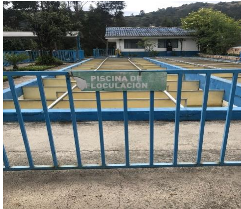
Ilustración 15: Piscinas de Floculación-Planta de Tratamiento de Agua Potable de Cochapamba Fuente: Elaboración Propia
