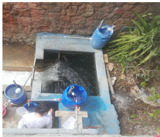
Ilustración 12: Etapa de Conducción-Planta de Tratamiento de Agua Potable de Cochapamba Fuente: Elaboración Propia
