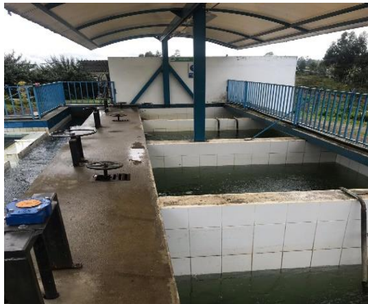
Ilustración 17: Área de Filtrado-Planta de Tratamiento de Agua Potable de Cochapamba Fuente: Elaboración Propia
