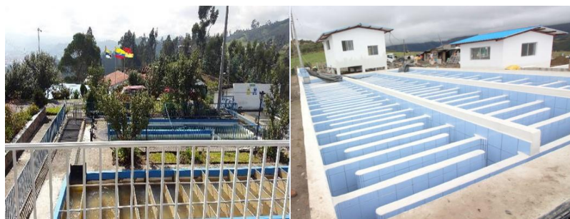
Ilustración 1: Plantas de Tratamiento de Agua Potable de los Sectores de Cochapamba y Rudio Fuente: (Archivo digital de la JAAPB, 2019)
