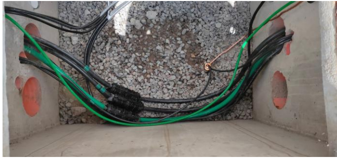
Figura 5. 3. Puesta a tierra del circuito de alumbrado público. EEASA
