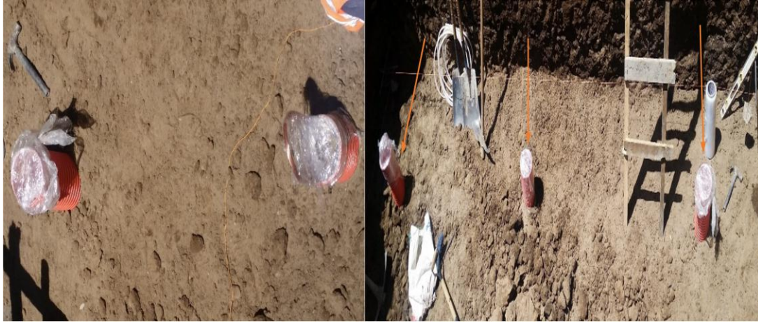
Figura 4. 64. Uniones protegidas con tubería. EEASA.
