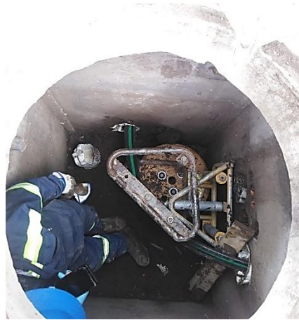
Figura 3. 12. Poleas para cambiar la dirección de los cables dentro del pozo. EEASA
