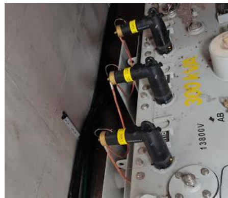
Figura 4. 24. Conexión de los pararrayos EEASA.
