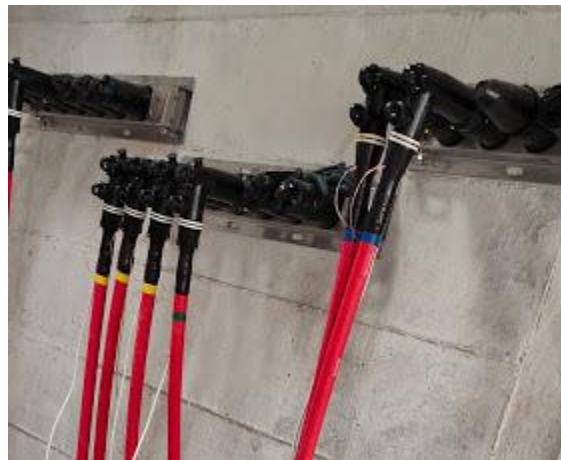
Figura 3. 71. Conectores tipo codo de 200 A EEASA.
