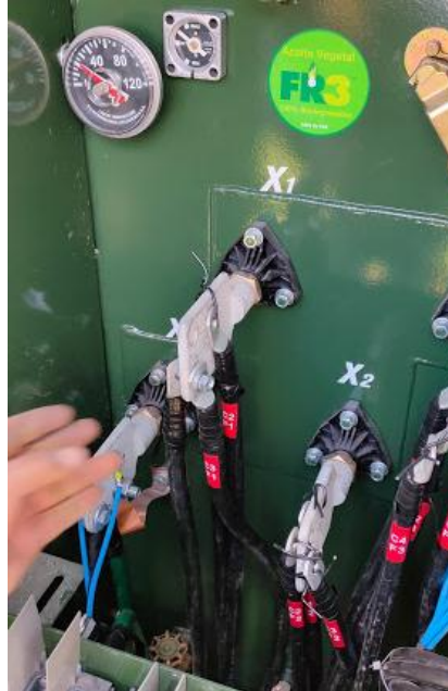
Figura 4. 8. Identificación de cada uno de los cables de bajo voltaje. EEASA
