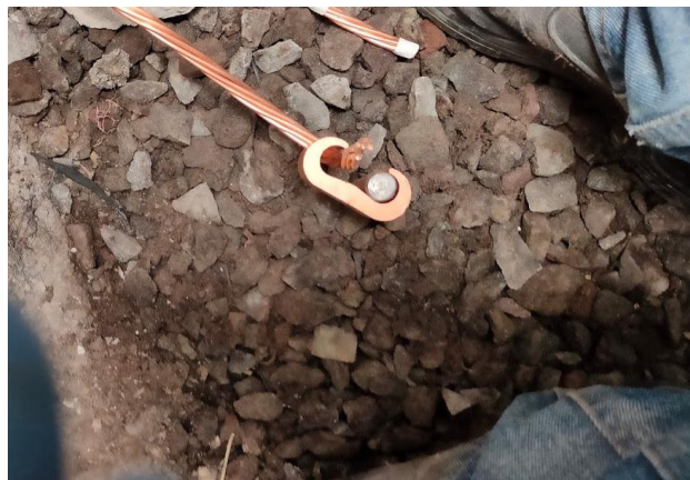
Figura 3. 96. Conector de puesta a tierra EEASA.
