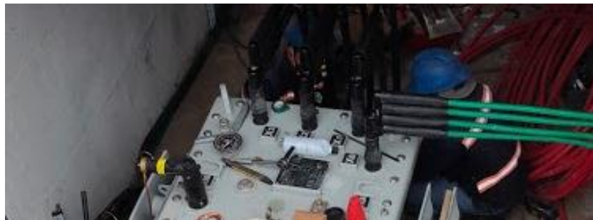
Figura 4. 29. Conexión de los neutros de los circuitos en el Bushing X_0 EEASA
