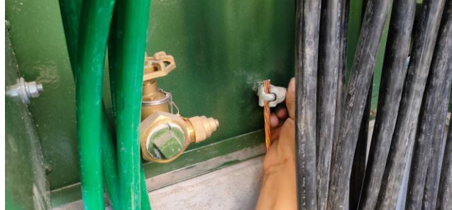
Figura 4. 12. Conexión del conector a tierra del transformador. EEASA
