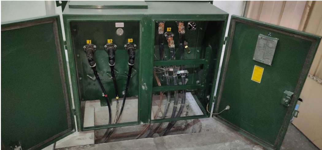
Figura 4. 1. Transformador trifásico pad mounted tipo radial.
