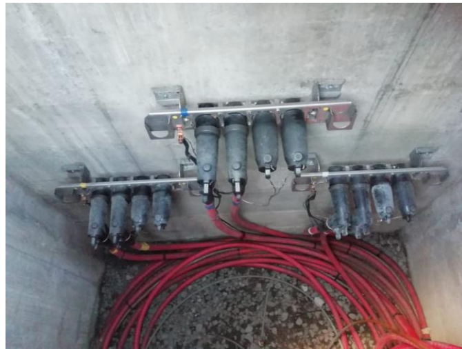
Figura 3. 59. Barras premoldeadas de 200 A conectado los conectores tipo codo de 200 A. EEASA
