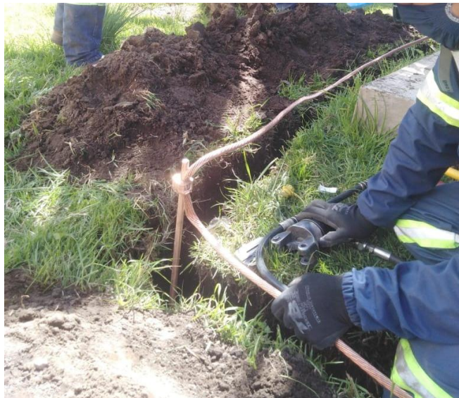
Figura 4. 63. Varilla Copperweld unida mediante conector tipo C al conductor. EEASA.
