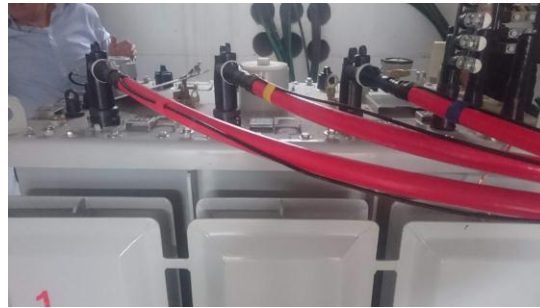
Figura 4. 23. Conectores tipo codo conectados en los bushing del transformador EEASA.
