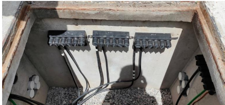
Figura 3. 95. Conexión de las fases y el neutro en cada una de las barras de bajo voltaje EEASA.
