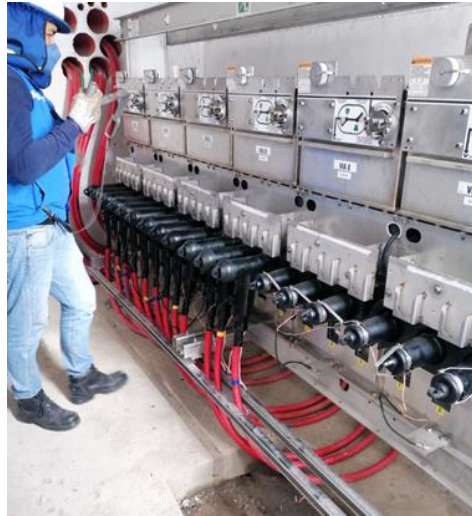
Figura 3. 75. Conector tipo codo de 600 A conectado a equipo de seccionamiento EEASA.
