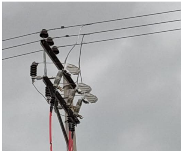
Figura 3. 81. Seccionadores fusible EEASA
