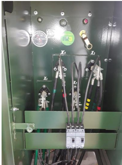
Figura 5. 2. Conexión de los circuitos de alumbrado público en la protección termomagnética de 32 A. EEASA.
