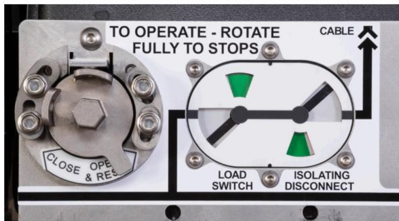
Figura 4. 33. Visibilidad de la posición del seccionador.[59]
