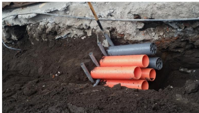
Figura 2.4. Separadores de ductos utilizados en Píllaro EEASA (Tubería color gris utilizados para telecomunicaciones y tubería naranja para distribución eléctrica..)
