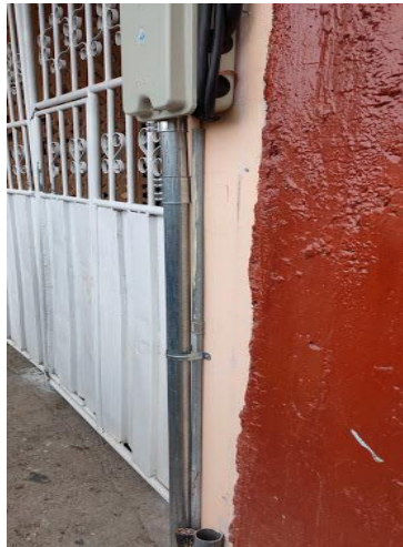
Figura 3. 97. La barra del neutro de la caja de distribución se conecta a la varilla de puesta a tierra exterior EEASA.
