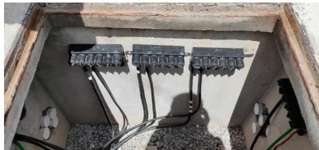
Figura 3. 94. Barras de derivación de bajo voltaje para cada una de las fases y el neutro. EEASA.
