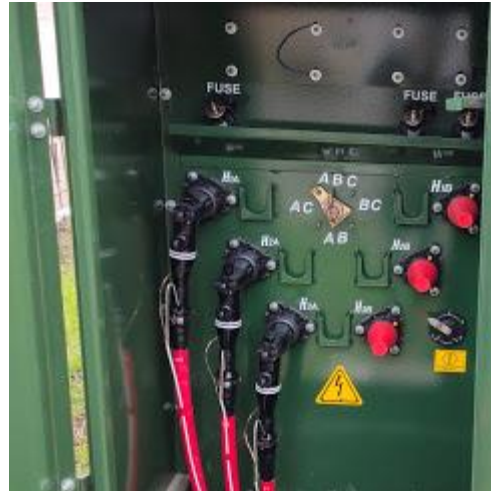
Figura 3. 72. Conectores tipo codo de 200 A colocados en un transformador pad mounted EEASA.
