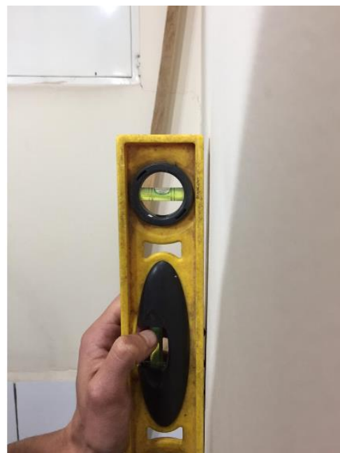
Figura 7. Hinchazón en mampostería de baños.
