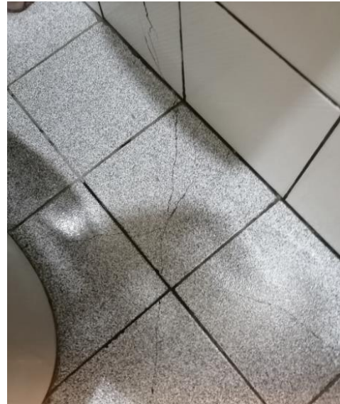
Figura 9. Grietas en revestimiento del piso
