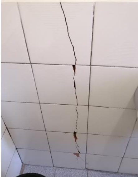
Figura 10. Grietas en revestimiento de paredes.
