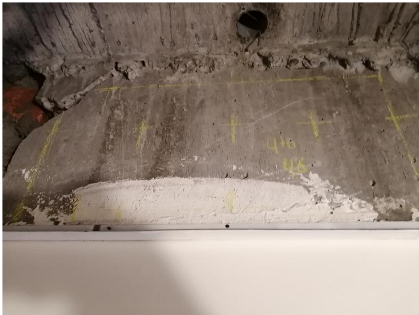
Figura 11. Fisura en la esquina superior izquierda de columna de la cuarta planta.
