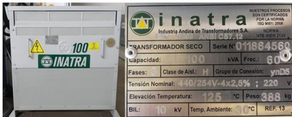
Figura 6.7: Transformador trifásico INATRA 100 kVA.
