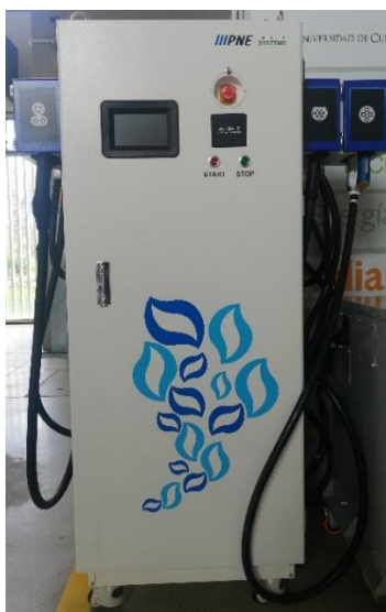
Figura 6.6: Estación de carga rápida de 50 kW de PNE Solution.
