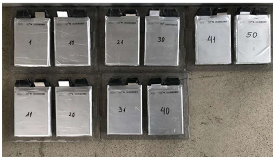
Figura 4.6 Todos los módulos de 5 baterías en serie usadas para armar el nuevo banco
