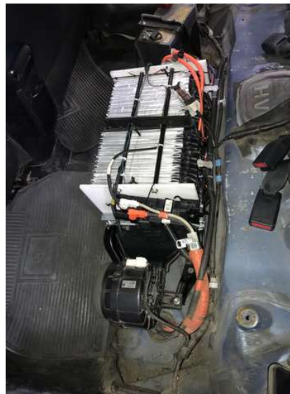
Figura 4.12 Nuevo banco de baterías montado sobre la estructura original y debajo del asiento trasero
