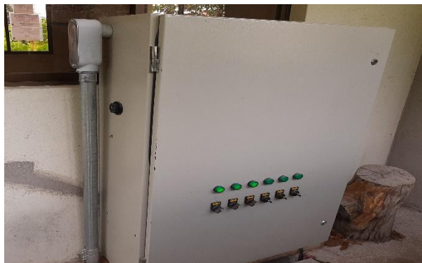
Ilustración 51: Condensador de energía de la Hostería Sol del Valle Autor (as): Paola León y Diana Zhunio Fuente: Hostería Sol del Valle Fecha: 28 de enero de 2020
