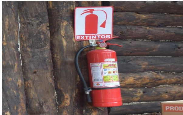
Ilustración 62: Extintor de fuego - hostería Chorro de Girón Autor (as): Paola León y Diana Zhunio Fuente: Hostería Chorro de Girón Fecha: 21 de enero de 2020
