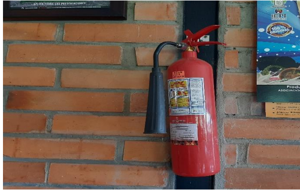
Ilustración 38: Extintor - Hostería Sol del Valle Autor (as): Paola León y Diana Zhunio Fuente: Hostería Sol del Valle Fecha: 21 de enero de 2020
