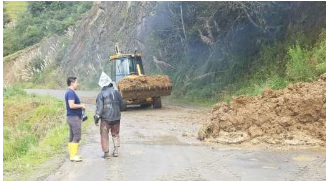
El fuerte invierno ha provocado algunos derrumbes. (FOTO: GAD Taday)
