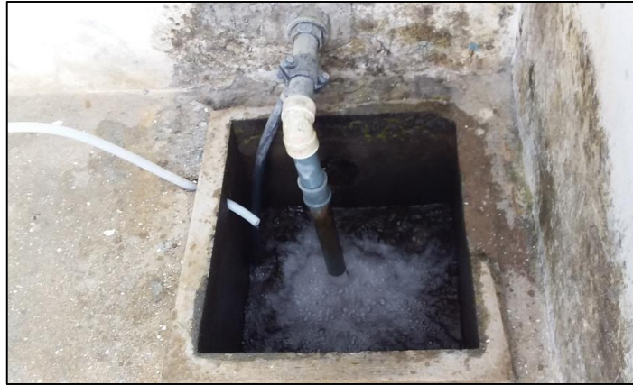
Fotografía 6. Cloración por goteo en el caudal de entrada.
