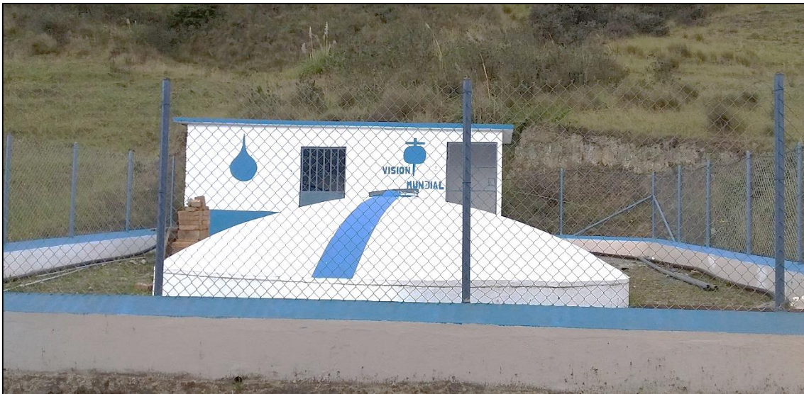
Fotografía 7. Caseta de cloración y tanque de reserva, altitud: 3.346 m.s.n.m.
