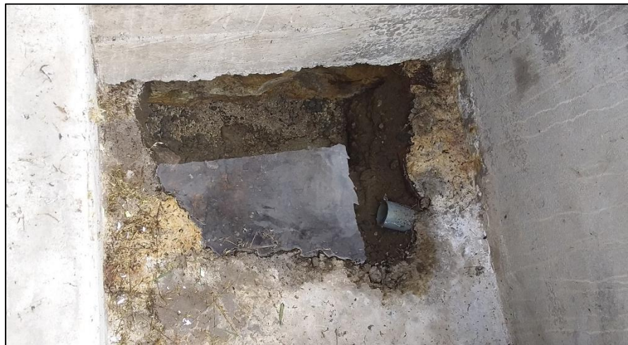
Fotografía 2. Vista interna, captación Tragneran Yaku.
