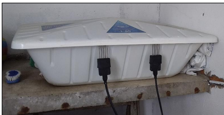
Fotografía 5. Tanque de preparación de hipoclorito de sodio, equipo Clorid L-60.
