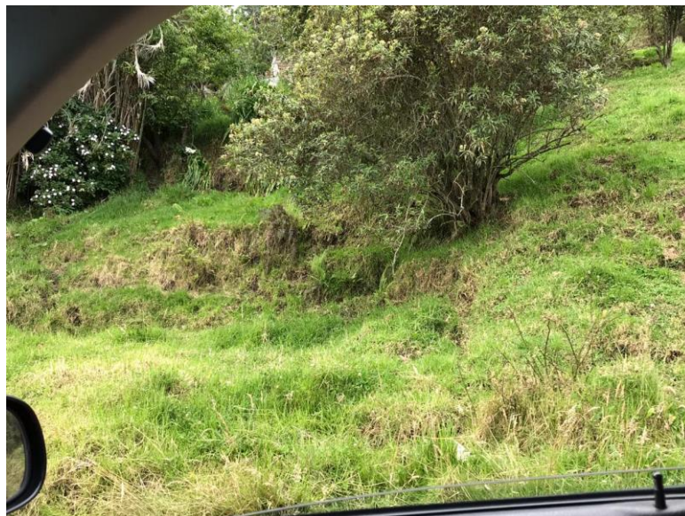
Imagen 9 sector 2 deslizamiento aledaño
