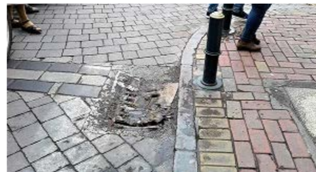
Fotografía 3.20: Alcantarillas dañadas en el sector la Merced.
