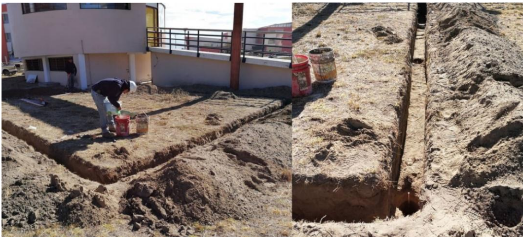
Figura 4.3 Instalación de la nueva puesta a tierra para el Data-Center de la facultad.
