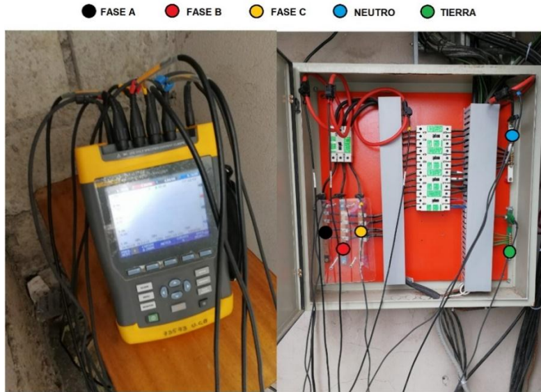
Figura 4.39 Conexión del equipo analizador en el tablero principal de la facultad.
