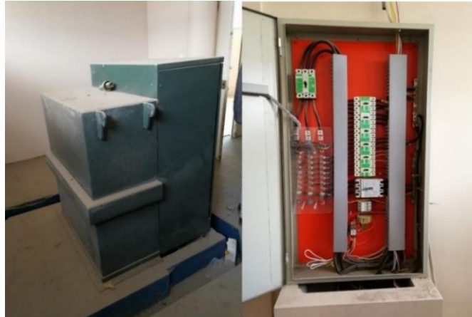
Figura 4.11 Ubicación del transformador y el tablero general de distribución.
