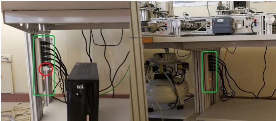
Figura 4.19 Evidencia de conexión de cargas por regleta.
