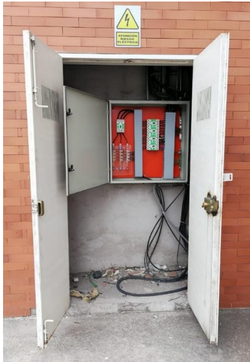
Figura 4.10 Tablero principal del edificio de la facultad.
