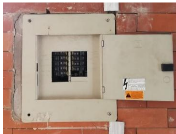
Figura 4.9 Subtablero de distribución ubicado en el primer nivel del edificio.
