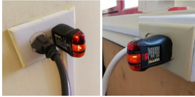
Figura 4.8 Evidencia de las fallas en los circuitos de tomacorrientes.
