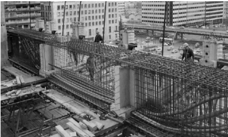
Vainas para el guiado de los cables postensados, en la obra del Banco de Bilbao
