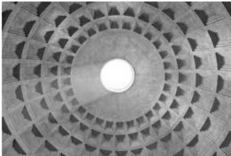
Detalles en corte y en perspectiva de la majestuosidad constructiva del Panteón
