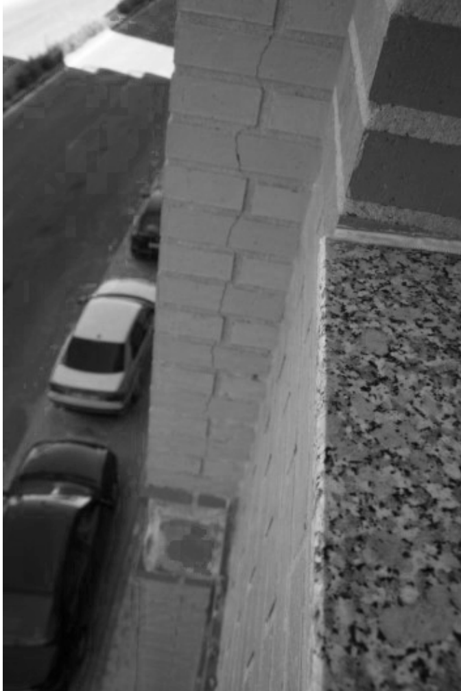
Grieta por dilatación. Unas delgadas fachaletas de ladrillo rodean una columna metálica, lo que induce al agrietamiento por la parte más frágil que se dibuja detrás el recorrido del soporte vertical
