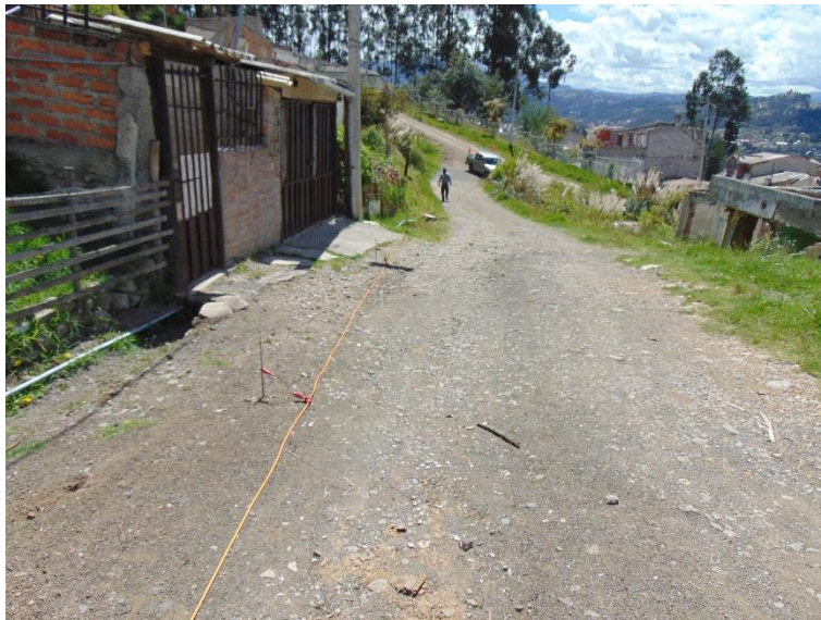
Foto N° 2 Levantamiento de la línea eléctrica LE-2
