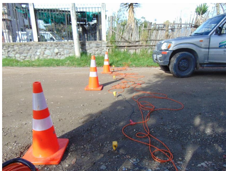
Foto N° 5 Levantamiento de la línea eléctrica LE-8
