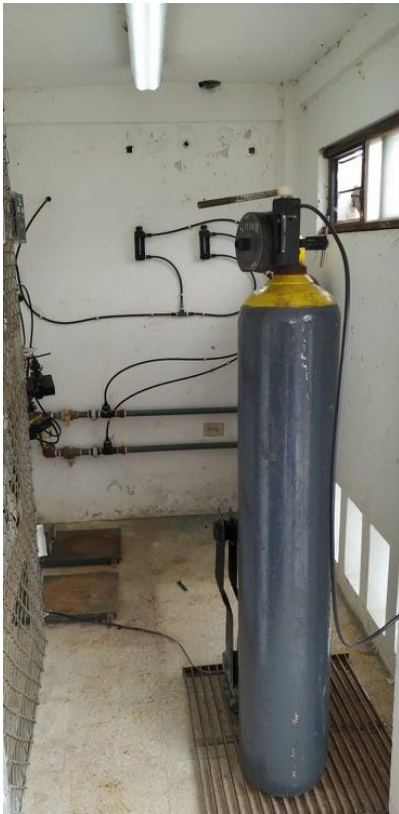
Ilustración 3 Sala de Cloración
