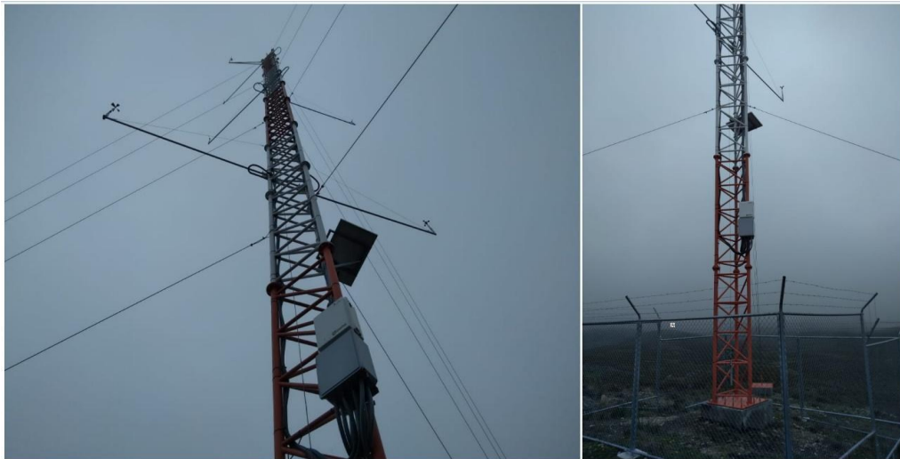
Figura 2. 9 Torre atirantada ubicada en Pimo, Fuente: Propia
