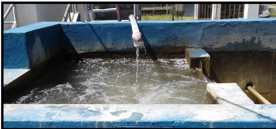
Ilustración 11. Dosificación de alcalinizante al 1% de concentración al tanque de mezcla rápida
