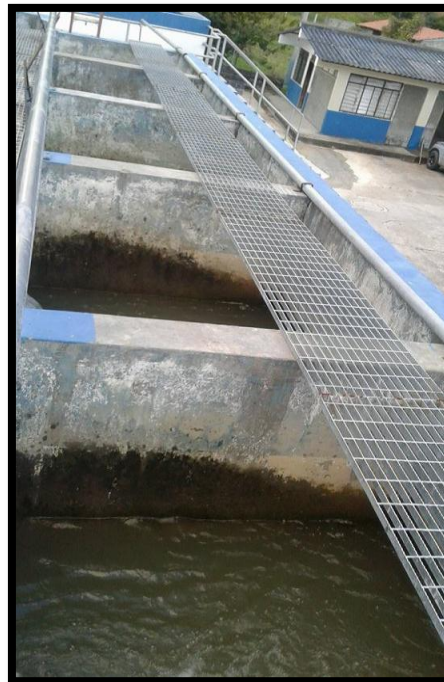
Ilustración 20. Filtros Planta de Tratamiento de Agua Potable Gualaceo (PTAP-G) Fuente: Autor
