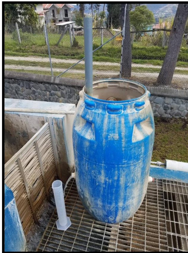
Ilustración 26. Mediciones de caudal para el aforado del tanque de dosificador de Sulfato de Aluminio Fuente: Autor
