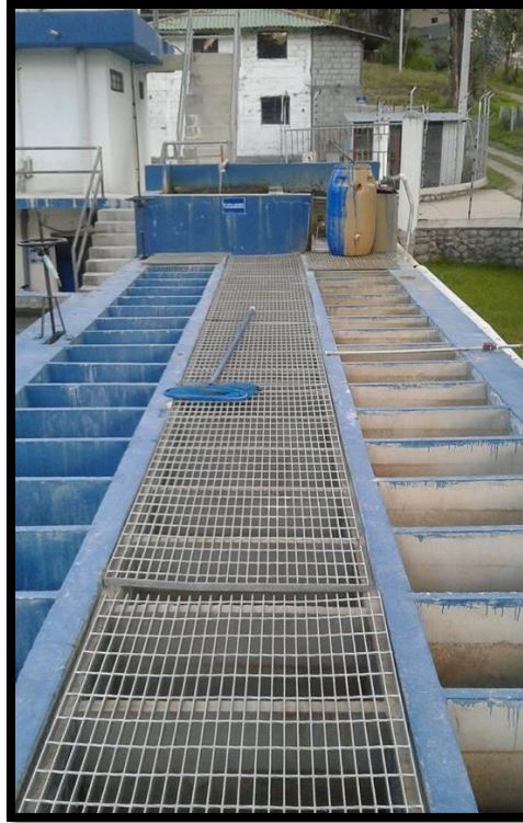
Ilustración 17. Bateria de Floculadores de flujo vertical Fuente: Autor
