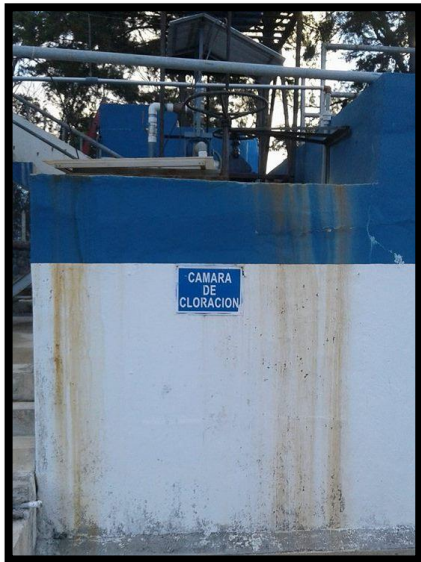
Ilustración 21. Cámara de Cloración Planta de Tratamiento de Agua Potable Gualaceo (PTAP-G) Fuente: Autor
