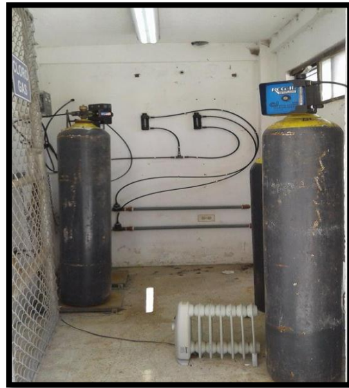
Ilustración 22. Distribución de tanques de cloro gas Fuente: Autor
