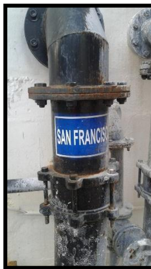
Ilustración 9. Tubería de entrada de agua de la captación hacia la Planta de Tratamiento de Agua Potable Gualaceo (PTAP-G)
