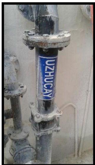
Ilustración 8. Tuberías de entrada de agua de captación hacia la Planta de Tratamiento de Agua Potable Gualaceo (PTAP-G)
