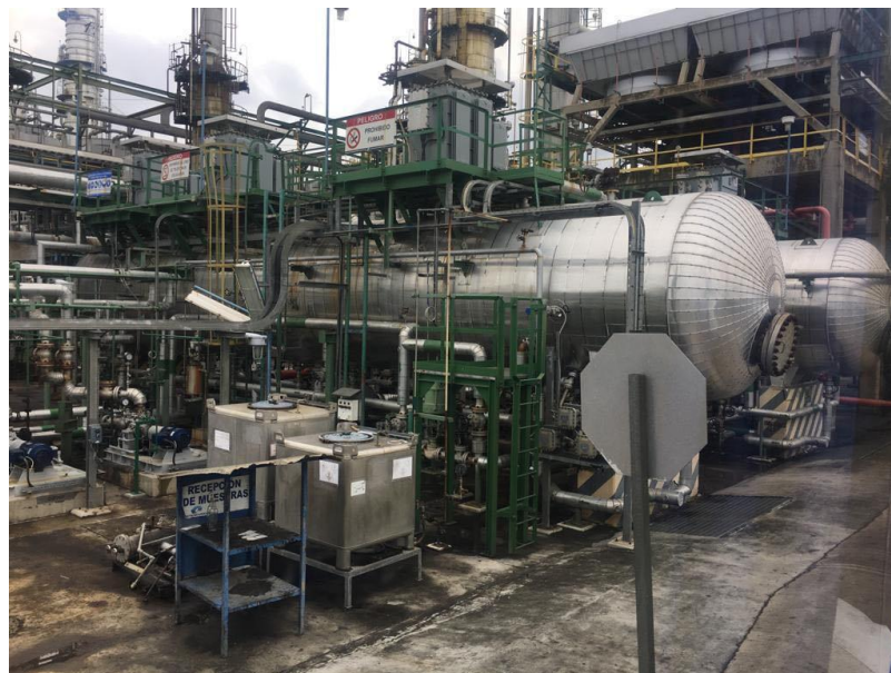
Figura 54. Fotografía de las unidades desaladoras en la Refinería Estatal de Esmeraldas.
