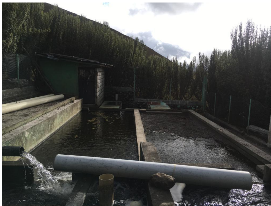
Ilustración 20 Filtros inundados (05 de enero del 2019)
