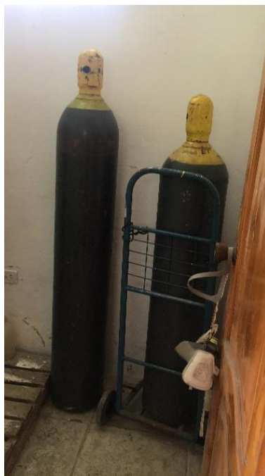
Ilustración 70 Almacenamiento del cloro gas.
