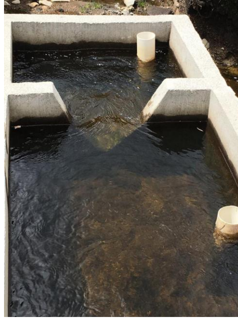
Ilustración 15. Cámara de captación sin válvula.
