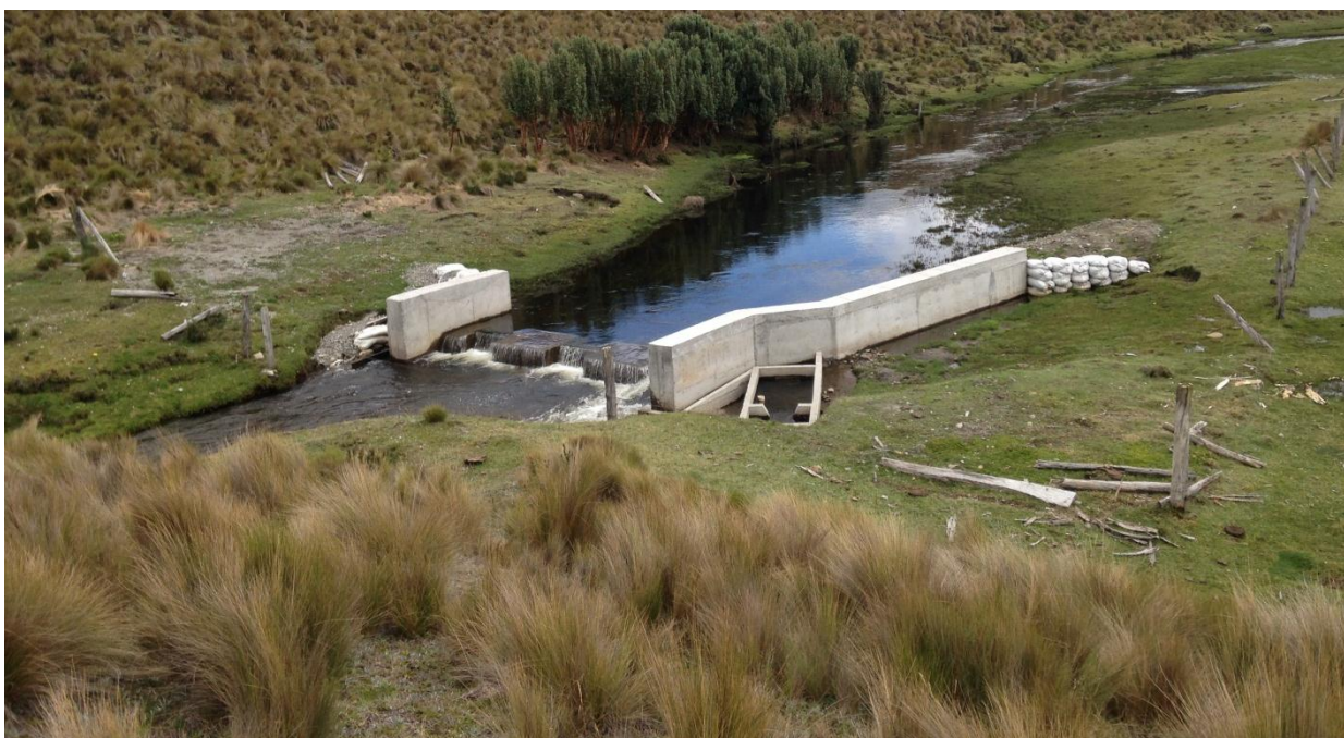
Ilustración 14. Cerramiento de la captación.
