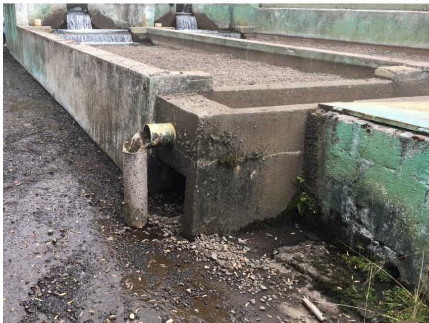
Ilustración 17 Estado filtros de pretratamiento
