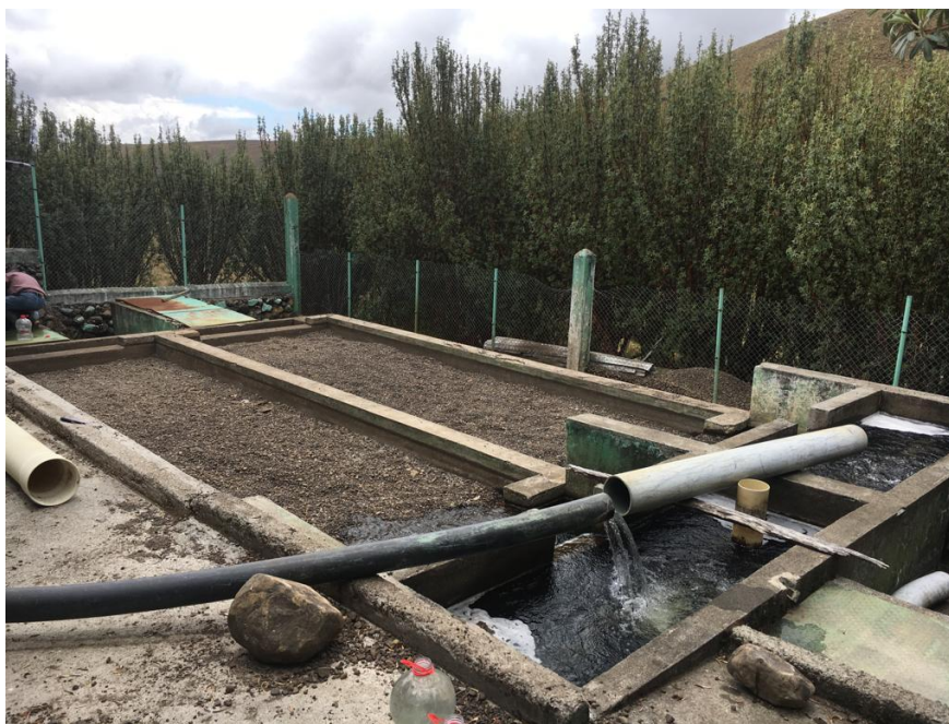
Ilustración 19 Estado de los Filtros de pretratamiento (29 de noviembre del 2018)
