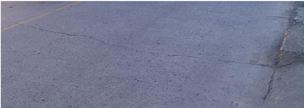
Fig. 41. Deterioro: agrietamiento lineal (transversal); severidad: Medio. Losa 1 de la sección 17 del carril #1 en la Avenida Loja.
