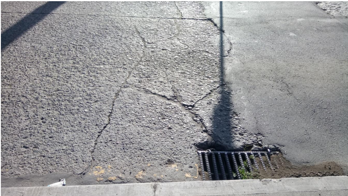
Fig. 65. Despedazamiento, severidad alta. Ubicada en la losa 6 de la sección 5 (carril #1).
