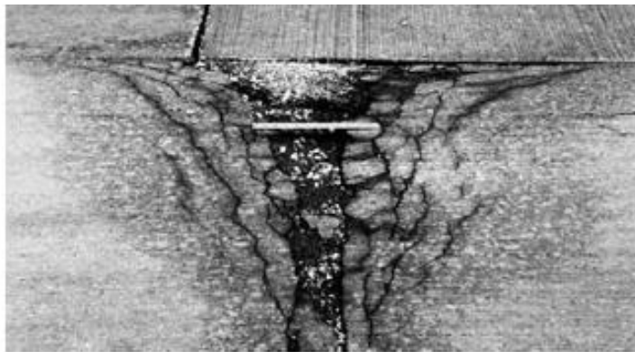
Fig. 5. Agrietamiento tipo "D". ASTM, 2011.
