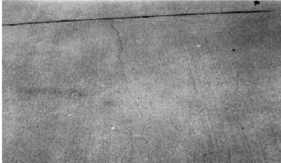
Fig. 18. Grietas de Contracción en losa. ASTM, 2011.
