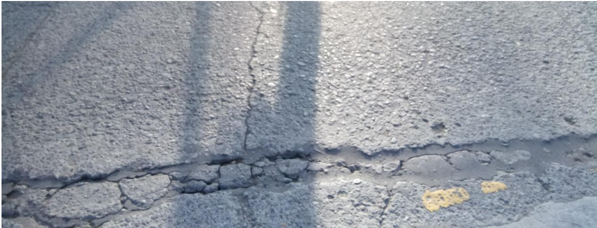
Fig. 64. Agrietamiento lineal, severidad alta. Ubicada en la losa 3 de la sección 5 (carril #1).
