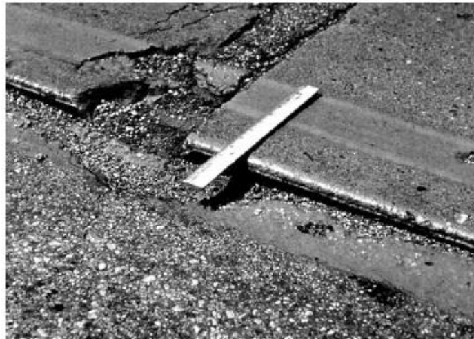
Fig. 8. Desprendimiento de hombreras. Nivel de severidad baja. ASTM, 2011.
