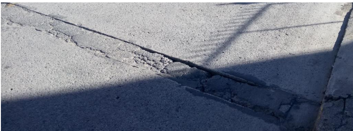
Fig. 42. Deterioro: Parcheo largo; severidad: Alta. Losa 3 de la sección 17 del carril #1 en la Avenida Loja.
