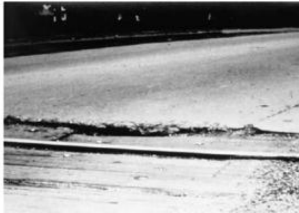
Fig. 15. Deterioro de cruce de ferrocarril de severidad alta. ASTM, 2011.
