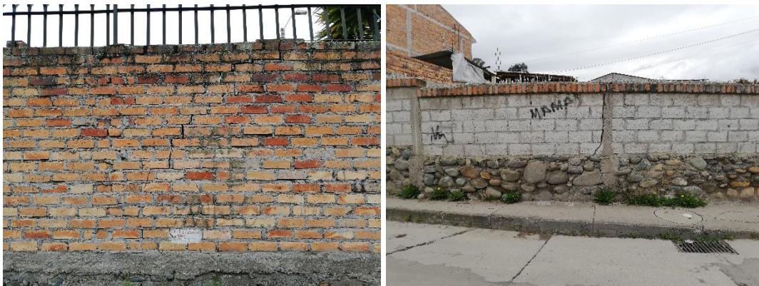
Ilustración 16. Fisuras típicas en paredes por efecto de expansión del suelo en el sector de Miraflores.
