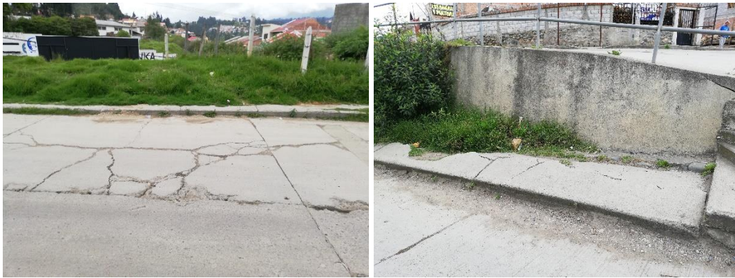
Ilustración 17. Rotura del pavimento y levantamiento de la vereda en el sector de Miraflores
