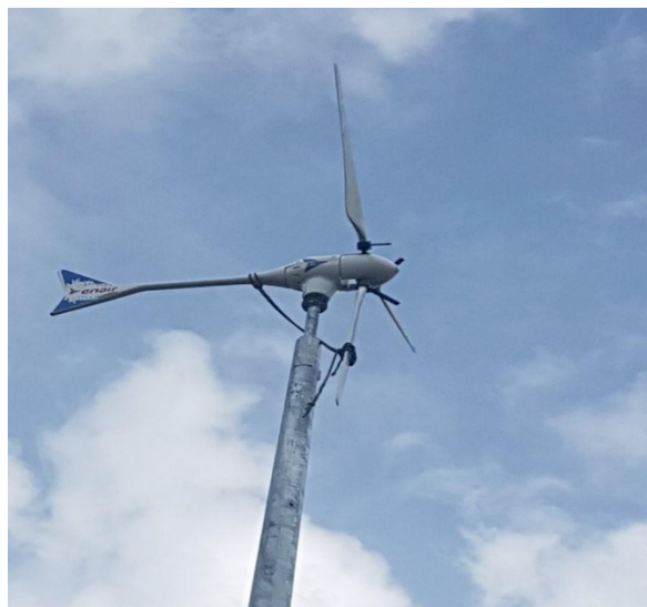
Figura 3-6 Turbina ENAIR E70 pro ubicado en la granja Irquis.
