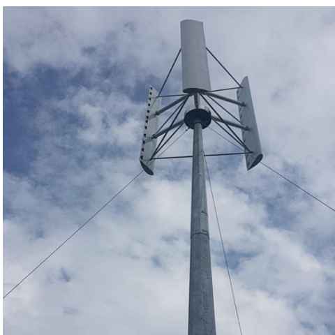
Figura 3-8 Aerogenerador TYD-WT-5000 ubicado en la granja Irquís.
