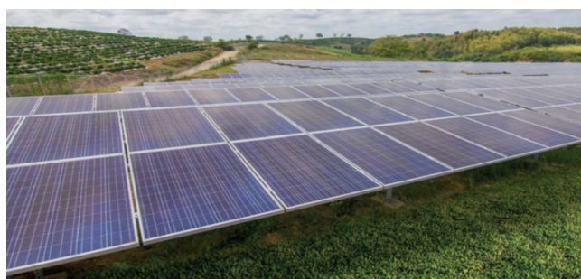
Figura 2-5 Central solar fotovoltaica Altgenotec, Guayas. (990kWp)
